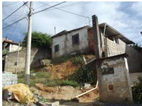
Figura 86 - Moradia em terreno com potencial de escorregamento no Bairro Guanabara
