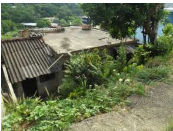
Figura 87 – Moradia abaixo do nível da rua no bairro Guanabara com problemas de escoamento das águas pluviais
