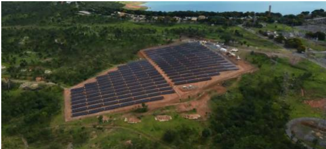
Figura 2 - UFV Três Marias GD construída na cidade de mesmo nome. Fonte: próprio autor.
