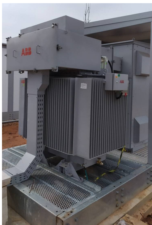
Figura 21 - Transformador elevador ABB 600V para 13,8kV. Fonte: próprio autor.
