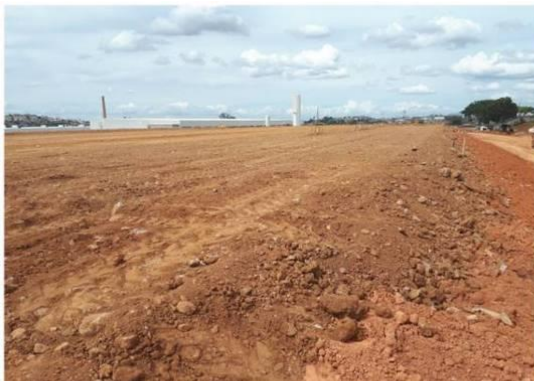
Imagem 6 – Execução do aterro de pré-carregamento – áreas 3a e 4, fonte: arquivo pessoal do autor (fevereiro 2018).
