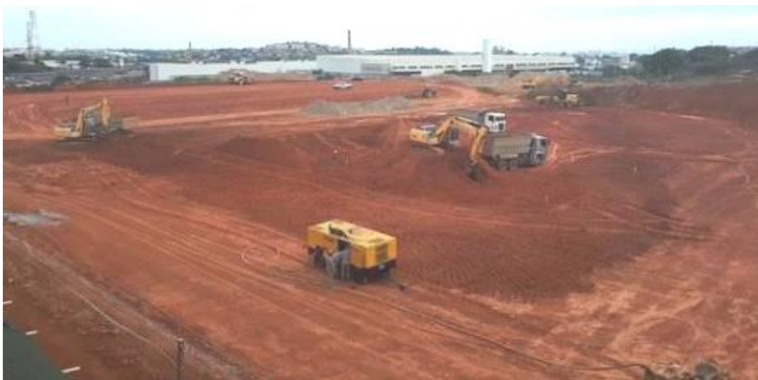
Imagem 5 – Preparação do terreno para início do aterro de pré-carregamento – áreas 3a e 4, fonte: arquivo pessoal do autor (janeiro 2018).
