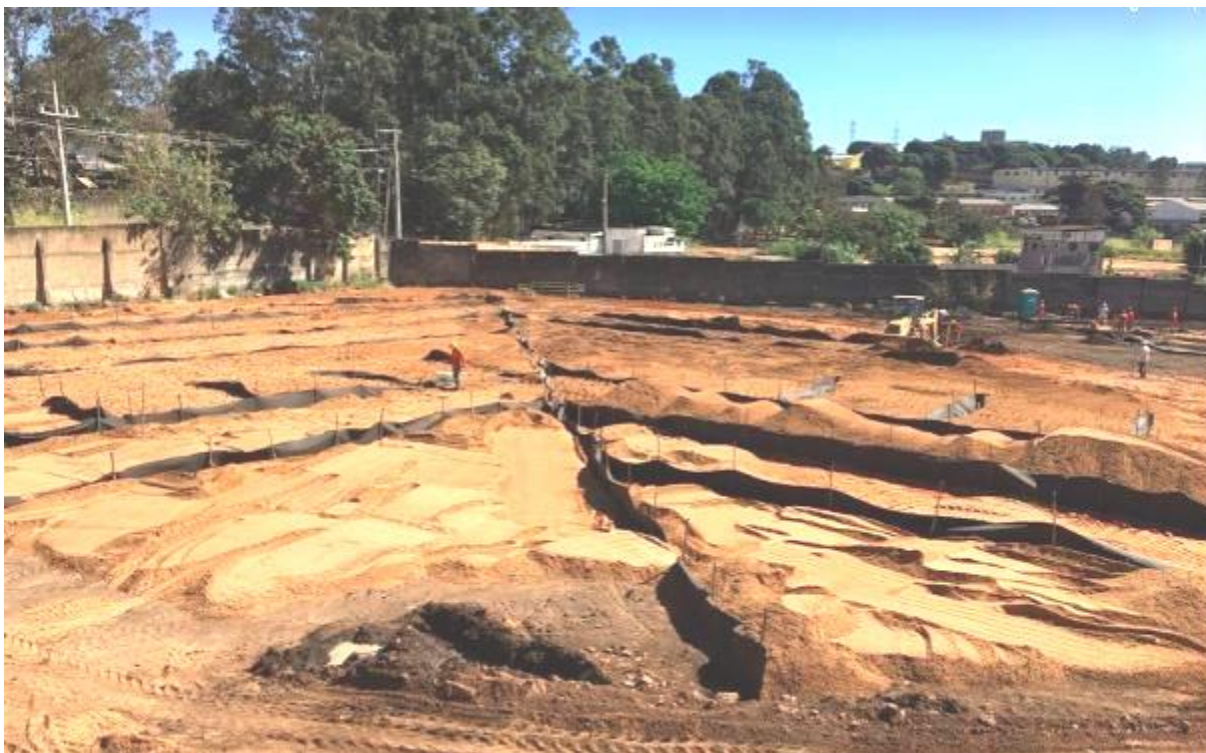
Imagem 14 – Execução de drenos espinha de peixe e colchão de areia nas áreas 3b e 3c, fonte: arquivo pessoal autor (junho 2018).
