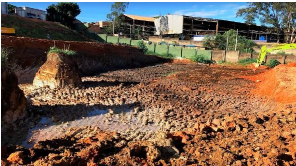
Imagem 19 – Corte do aterro de pré-carregamento das áreas 3b e 3c, fonte: arquivo pessoal autor (setembro 2018).
