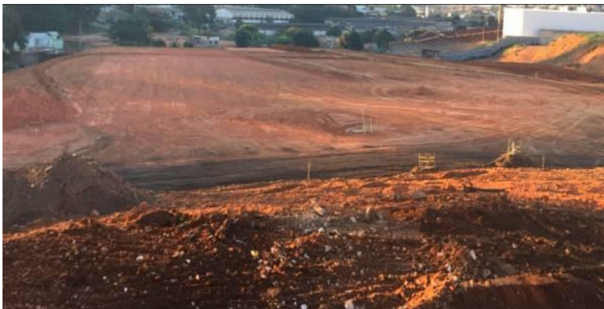
Imagem 17 – Finalização do aterro de pré-carregamento da área 3c, fonte: arquivo pessoal autor (agosto 2018).
