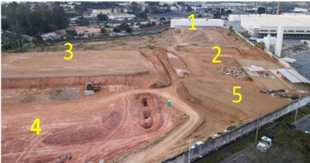
Imagem 9 – Finalização do aterro de pré-carregamento das áreas 3a e área 4, subdivisão das áreas in loco, fonte: arquivo da empresa Alfa (abril 2018).
