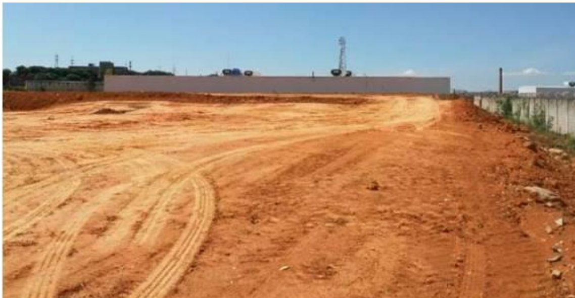
Imagem 24 – Finalização do aterro de pré-carregamento das áreas 1, fonte: arquivo pessoal autor (janeiro 2019).
