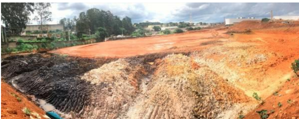
Imagem 21 – Área não drenada, fonte: arquivo pessoal autor (outubro 2018).
