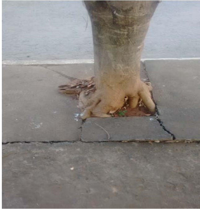
Figura 8 – Calçamento na avenida danificado por raízes de árvore
