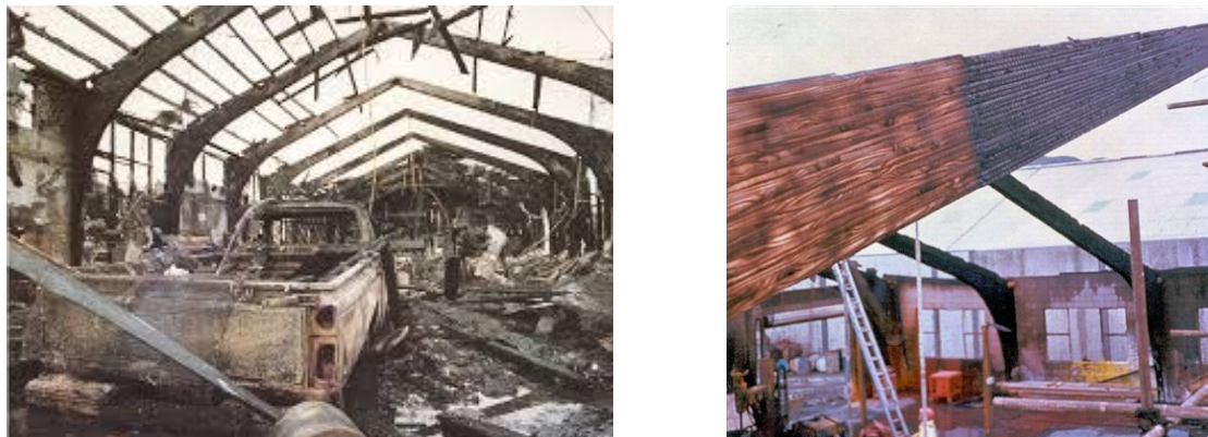
Figura 2.9 - Estrutura aporticada/MLC/Morrison Printing Inks Machinery Ltd pós incêndio.
