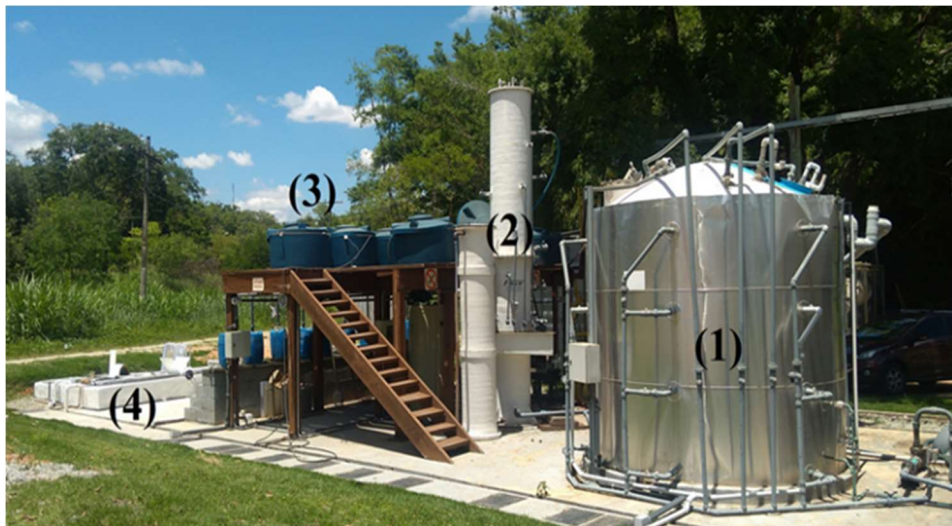
Figura 4-1 - Plataforma de Metanização de Resíduos Alimentares (pMethar), com suas diferentes etapas de tratamento: (1) Reator anaeróbio de mistura completa; (2) Reator UASB; (3) Separador sólido-líquido e; (4) LAT
