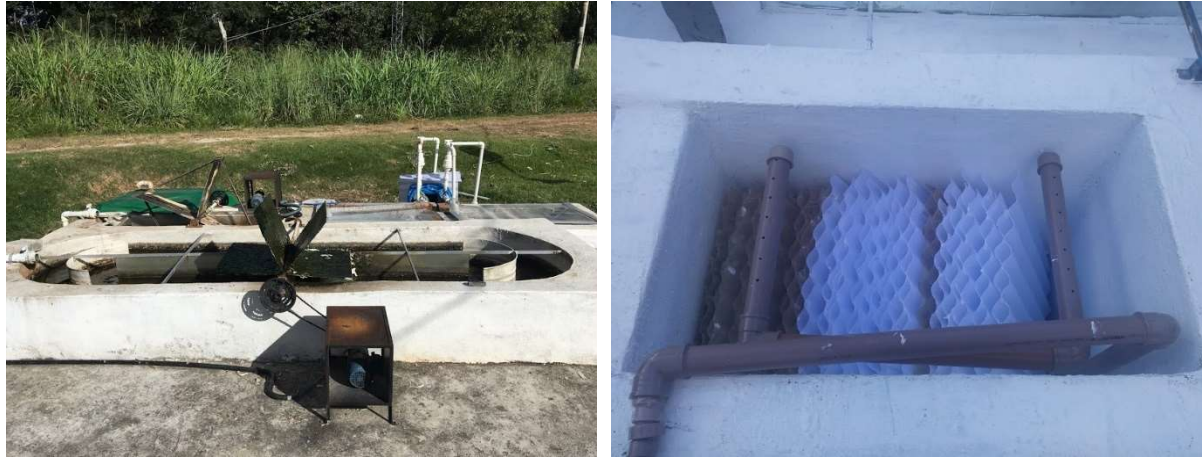
Figura 4-2 – LAT e decantador localizados na plataforma pMethar – Campus Pampulha da UFMG
