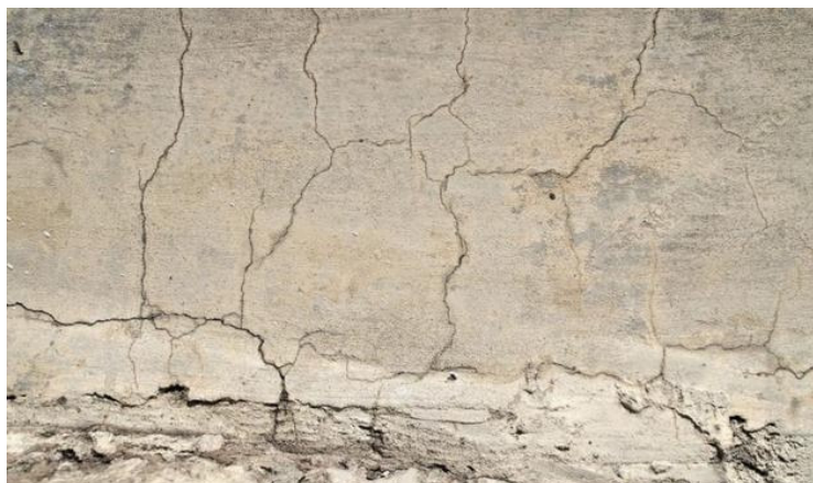
Figura 11: Fissuras devido a retração térmica
