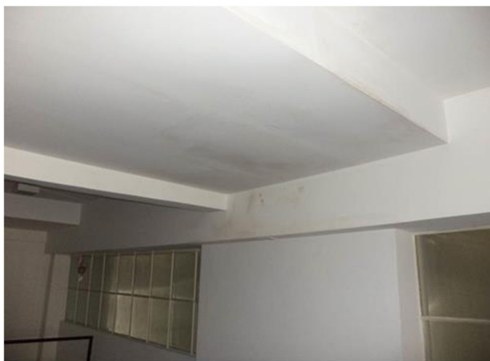
Figura 24: Infiltração das paredes e laje do teto.
