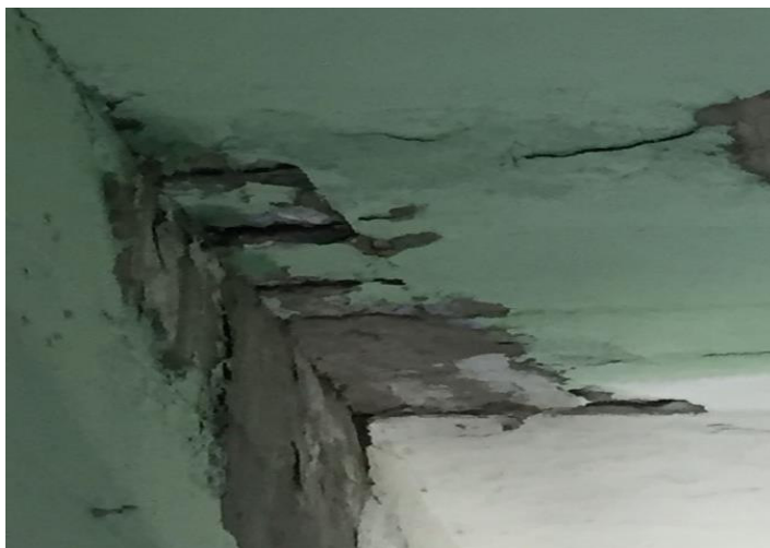
Figura 6: Corrosão das armaduras em ambiente úmido
