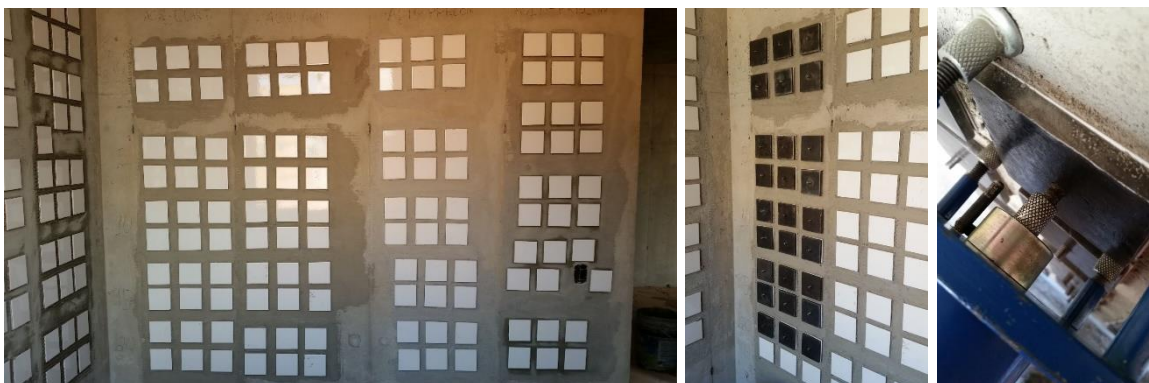
Figura 7 – Assentamento dos corpos de prova, colagem de chapa metálica e ensaio de arrancamento
