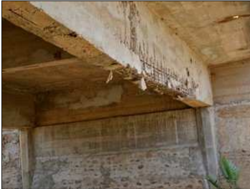
Figura 2: Deslocamento de placas de concreto, estrutura da ponte está bem comprometida e ameaça desabar.
