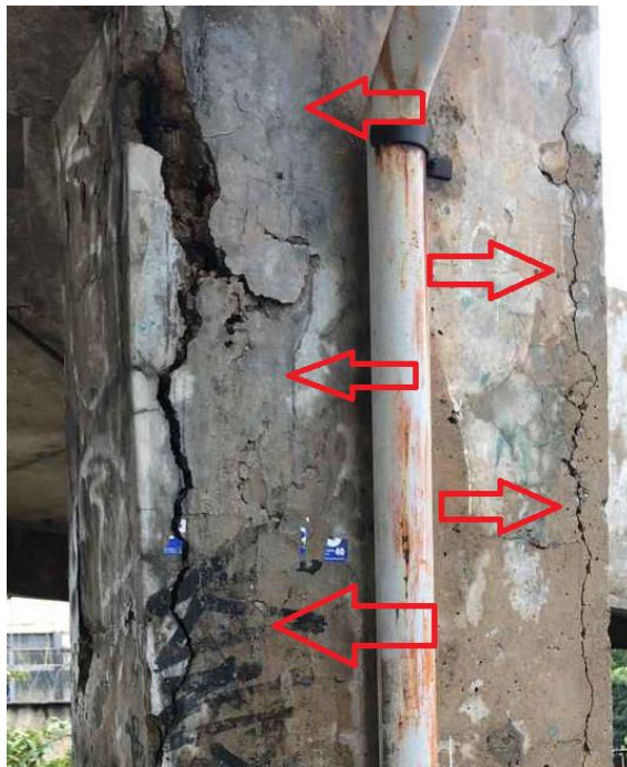
Figura 16- Deslocamento e fissuras ao longo do pilar
