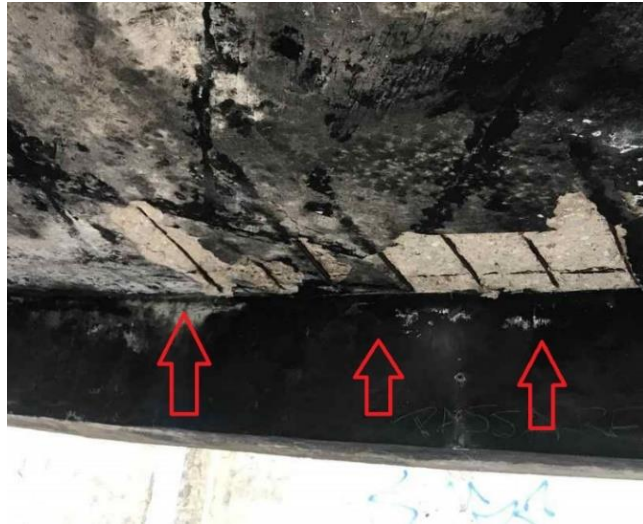
Figura 15- Deslocamento na laje da passarela
