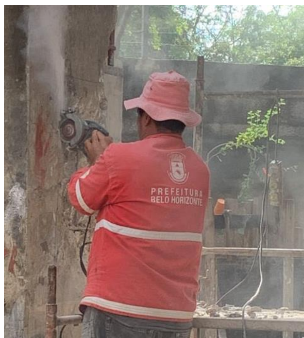
Figura 30 -Delimitação da área escarificada no pilar da passarela da Rua Jose Viola
