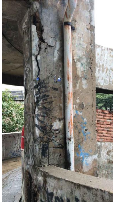
Figura 12- Deslocamento do concreto devido ao aumento de seção da barra de ferro no processo corrosivo.
