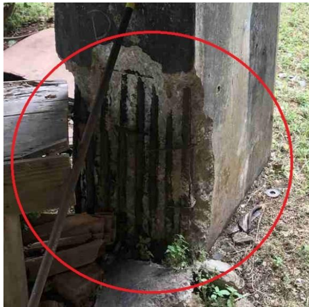
Figura 14- Armaduras expostas na base do pilar
