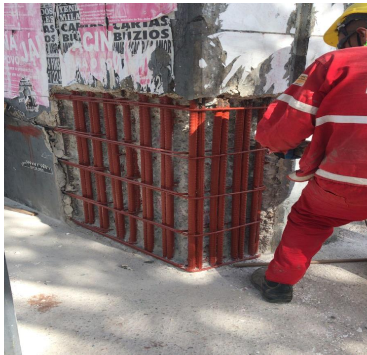
Figura 39- Aplicação de inibidores catódicos na estrutura (cromato de Zinco) do viaduto da Lagoinha
