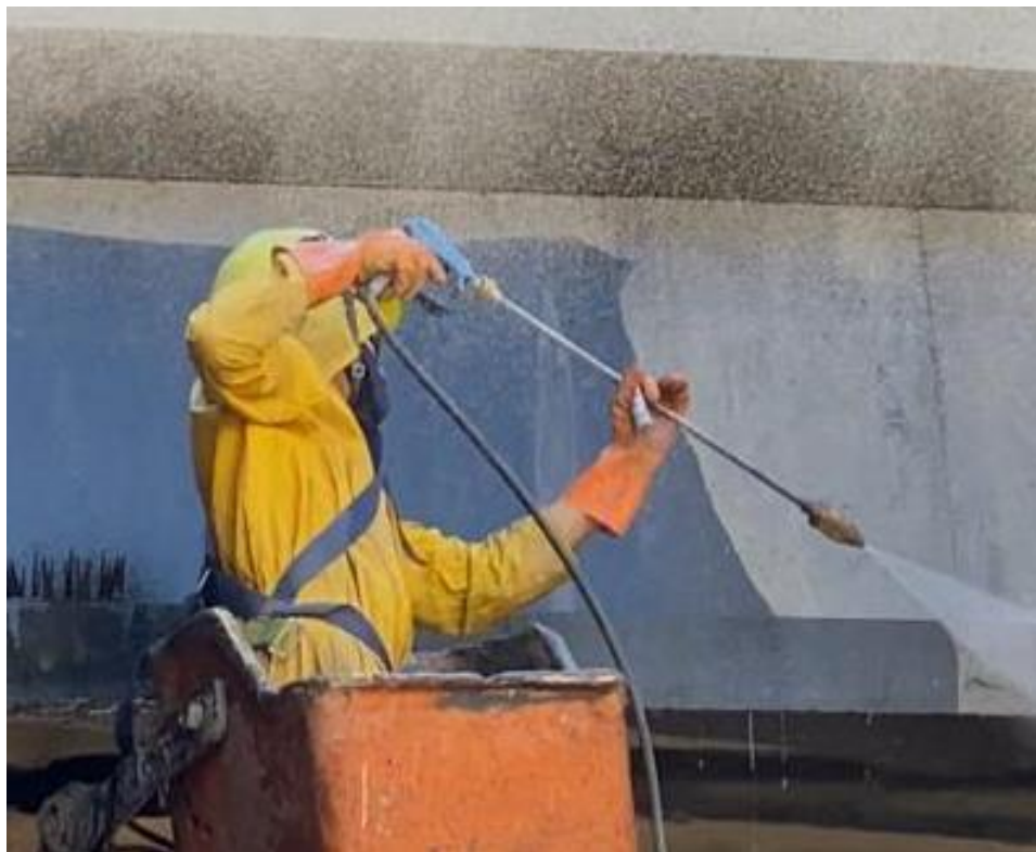
Figura 18- Limpeza das vigas do complexo da lagoinha, na entrada do túnel exclusivo para ônibus do túnel da lagoinha
