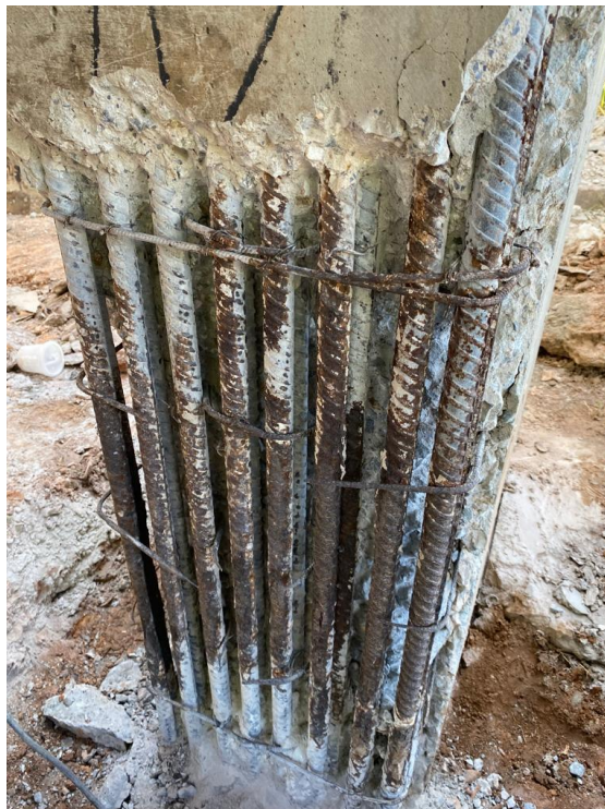
Figura 25- Face do pilar totalmente escarificada da Rua Jose Viola
