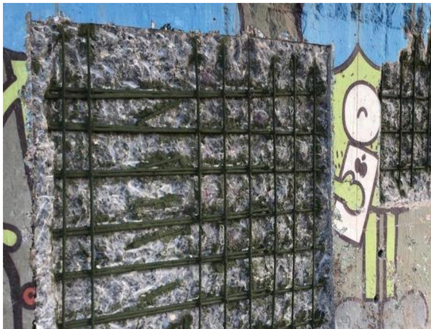
Figura 38- Aplicação de inibidores anódicos na estrutura (sikatop 108) no viaduto da Av Americo Vespúcio
