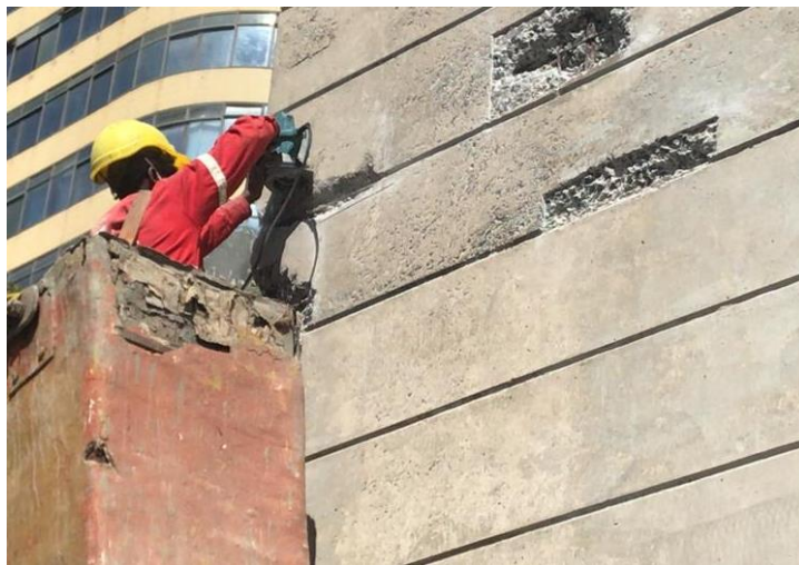
Figura 29- Delimitação da área escarificada no monumento da praça Rio Branco
