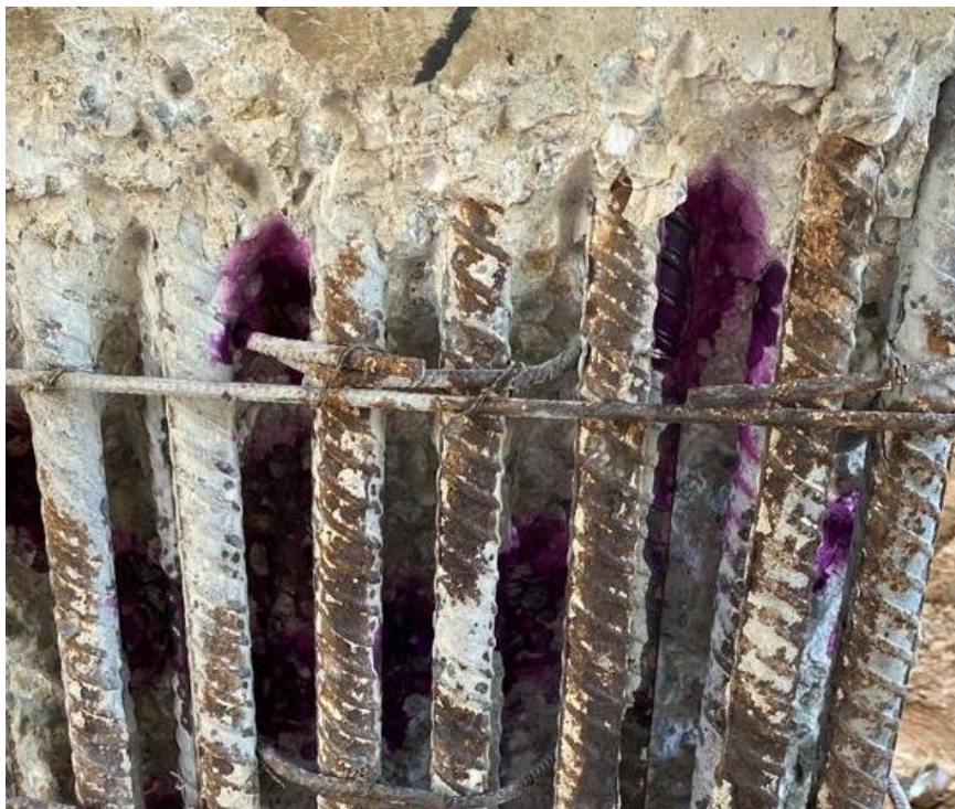
Figura 28- Aspersão de fenolftaleína na estrutura do concreto, constatando um Ph acima de 9,5
