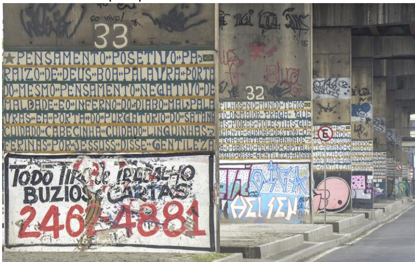
Figura 1 - Pilares do viaduto Paulo de Frontin antes de ser pintado pela prefeitura do Rio de Janeiro.
