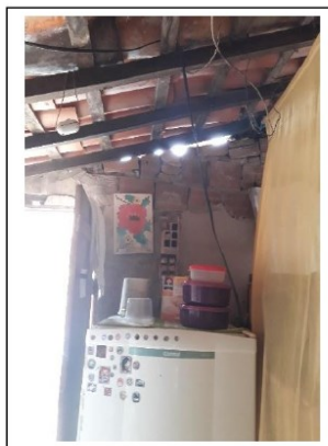
Edelma de Araújo Vista interna – Encunhamento mal executado, fresta entre parede e cobertura.
