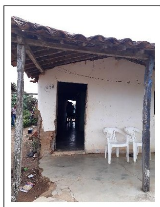
Alessandra da Silva Vista frontal – Revestimento externo comprometido, parede de taipa exposta.
