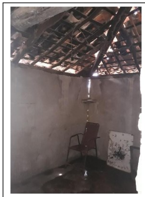
José Aloízio de Jesus Farias Vista interna – Telhamento precário e frestas entre parede e cobertura.
