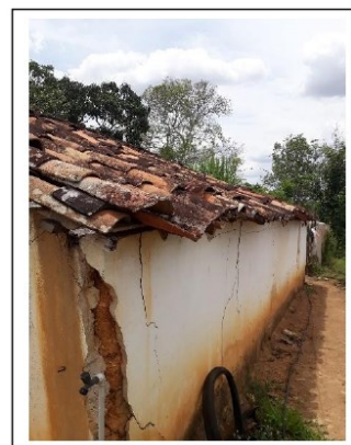
José Romeo dos Santos Vista lateral (2) – Telhas antigas e diversas fissuras. Estrutura comprometida.
