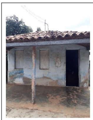
Josefa Alves Barreto Lima Vista frontal – Revestimento e sustentação beiral deteriorados.
