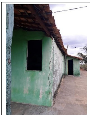
Josélia Rodrigues de Andrade Silva Vista lateral – Presença de inúmeras fissuras (recalque excessivo).
