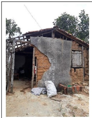
José Aloízio de Jesus Farias Vista frontal – Cobertura com ausência de telhas, revestimento externo danificado.
