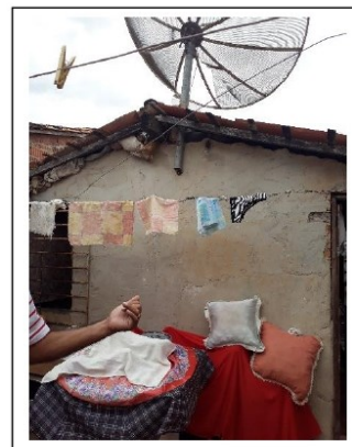
Edelma de Araújo Vista do fundo – Madeiramento e cobertura comprometidos.
