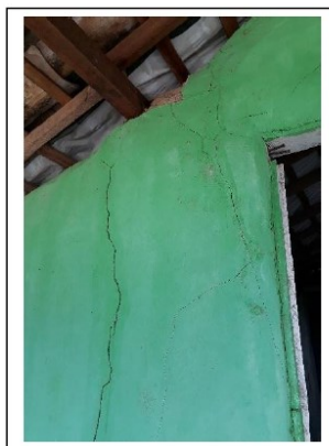
Josélia Rodrigues de Andrade Silva Vista frontal – Presença de inúmeras fissuras (recalque excessivo).
