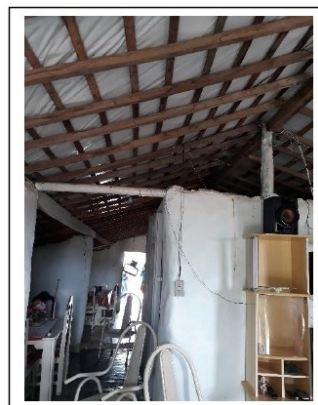
Josélia Rodrigues de Andrade Silva Vista interna – Estrutura de sustentação do madeiramento precária.
