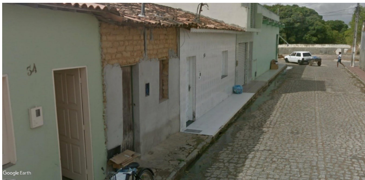
Figura 60 – Casa construída com a técnica de adobe, sendo coberta por revestimento cimentício no município de Frei Paulo/SE
