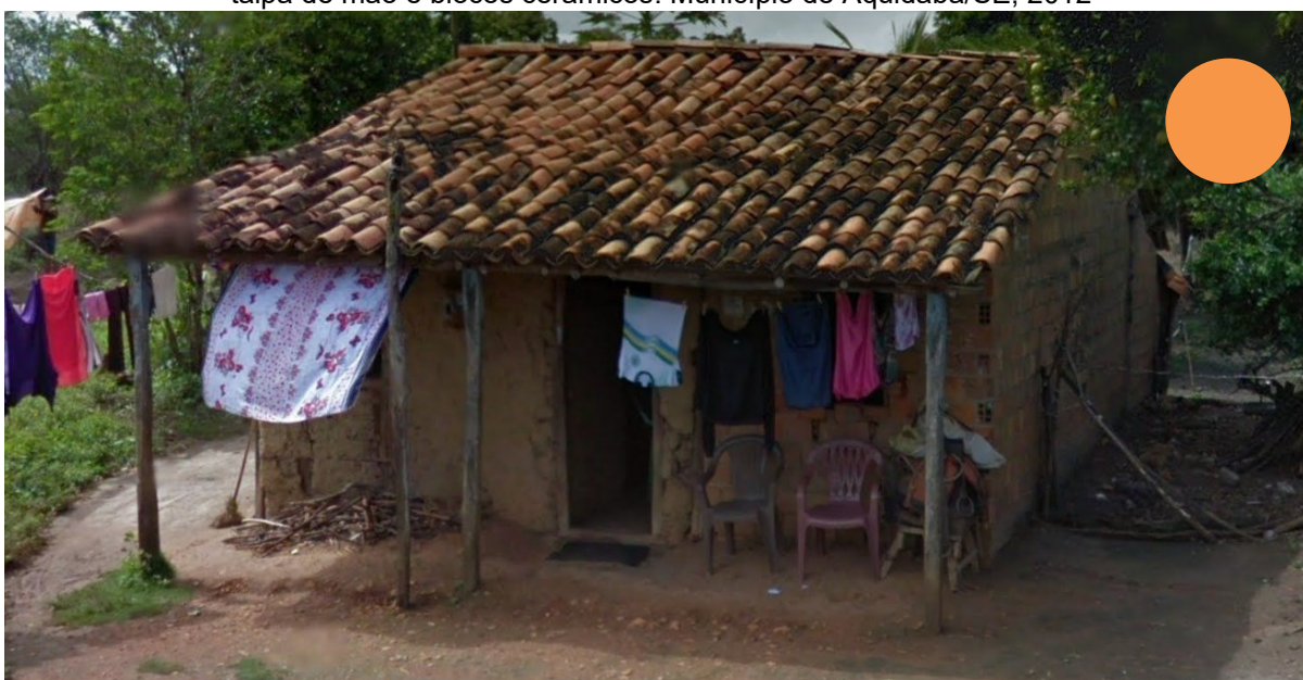
Figura 59 – Casa que possui um misto de técnicas construtivas e visíveis no levantamento digital: taipa de mão e blocos cerâmicos. Município de Aquidabã/SE, 2012
