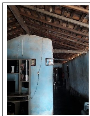
Josefa Alves Barreto Lima Vista interna – Madeiramento e cobertura comprometidos.
