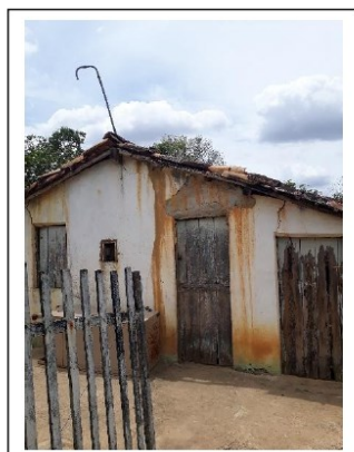
José Romeo dos Santos Vista frontal – Processo de Infiltração em estado avançado, perda da função da cobertura.
