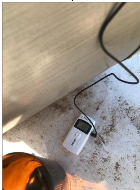
Figura 4.7 – Detalhe da sonda de temperatura inserida no interior do boiler
