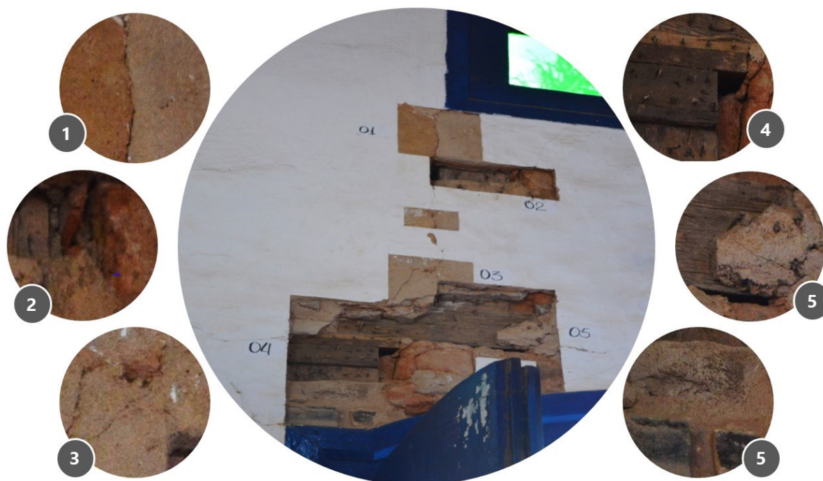
Figura 6 - Diversidade de materiais e técnicas construtivas encontradas em uma parede – Detalhes ampliados das janelas de prospecção
