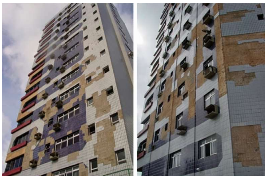
Figura 20: Deslocamento em fachada
