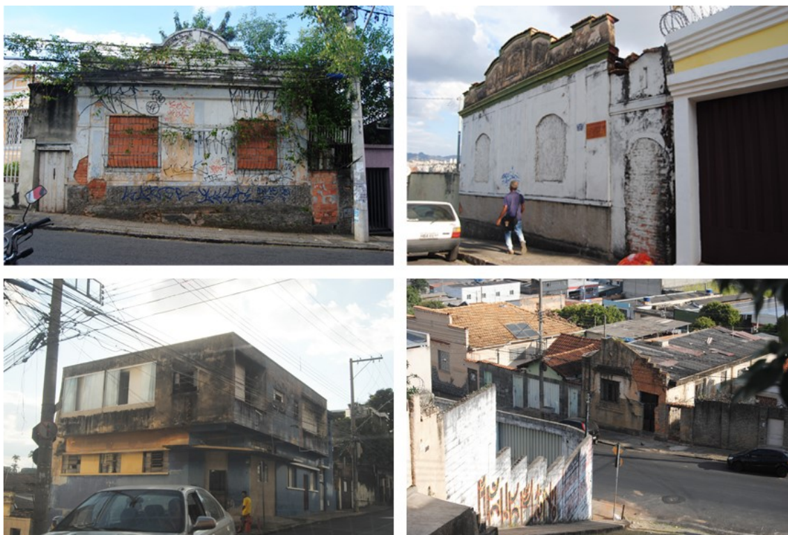
Figura 5 – Estado de conservação dos imóveis
