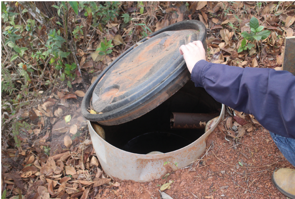
Figura 32 — Uma caixa de passagem do rêgo de cima
