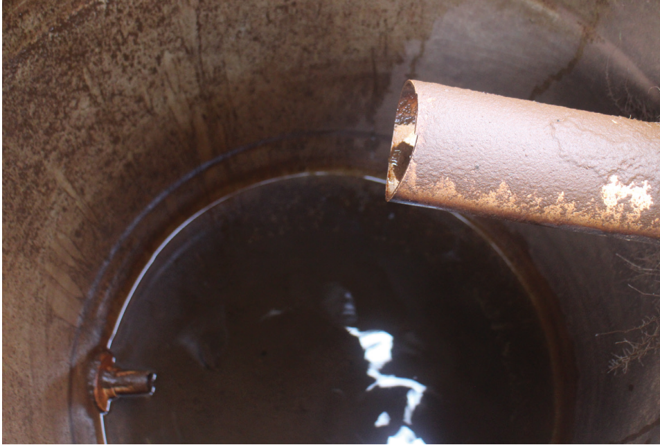
Figura 33 — Caixa de passagem
