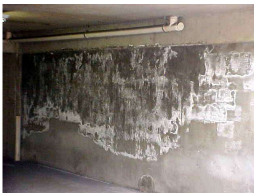
Figura 02 – Umidade por eflorescência
