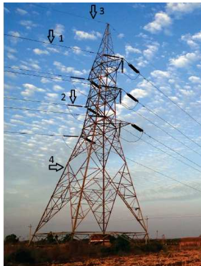
Figure 11 – Elementos de uma LT trifásica aérea: (1) cabos condutores; (2) isoladores; (3) cabos para-raios e (4) torres de transmissão - adaptado de (Paganotti, 2012).
