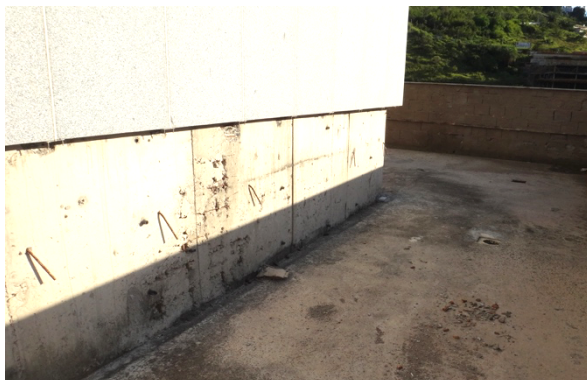
Figura 22: Ausência de tratamento das ferragens e dos nichos de concretagem, antes da montagem da fachada ventilada. Fonte: Arquivo da autora.
