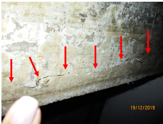
Figura 9: Trinca indicativa de corrosão de armadura. Fonte: Arquivo da autora
