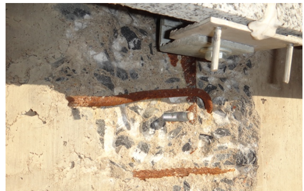
Figura 23: Ausência de tratamento da ferragem, antes da montagem da fachada ventilada. Fonte: Arquivo da autora.
