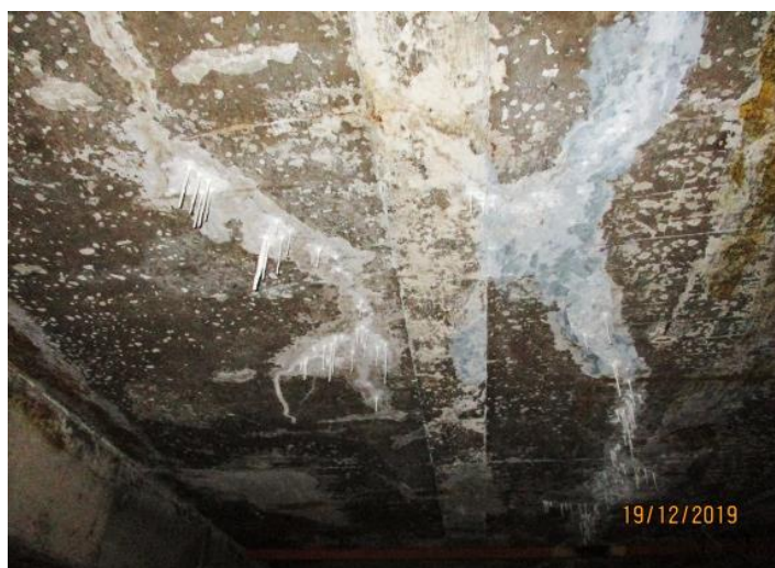
Figura 24: Infiltração causada por deficiência de impermeabilização do pilotis. Fonte: Arquivo da autora.
