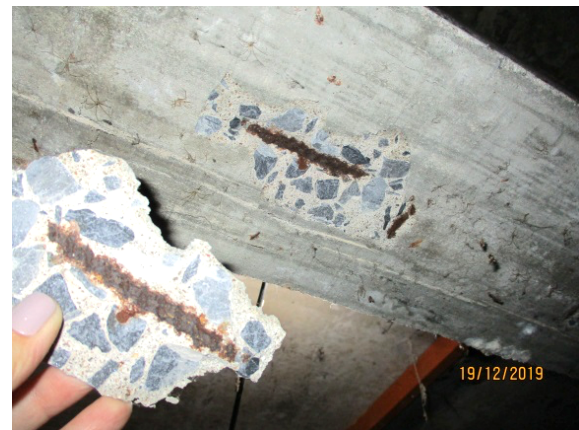
Figura 10: Deslocamento e corrosão de armadura. Fonte: Arquivo da autora.
