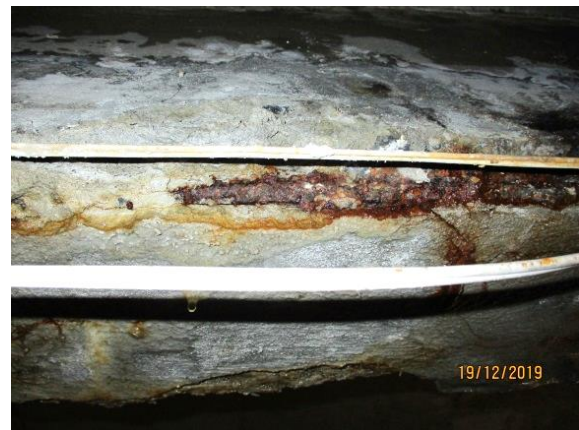
Figura 14: Carbonatação, deslocamento e corrosão de armadura. Fonte: Arquivo da autora
