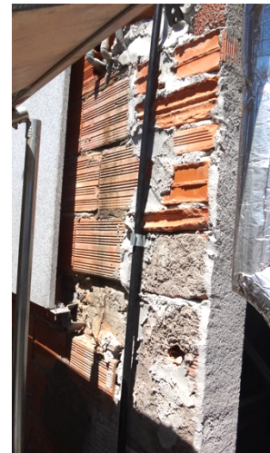
Figura 20: Deficiência de impermeabilização da alvenaria. Fonte: Arquivo da autora.
