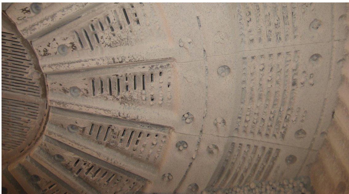
Figura 5.7: Obstrução do diafragma de descarga do moinho, com vedação incisiva da região periférica.
