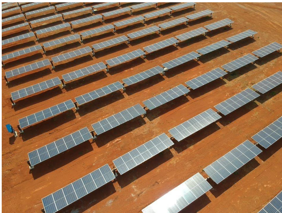
Figura 26 - TRJHT42PDR-WS instalado na usina Stella Maris. Fonte: Autor.
