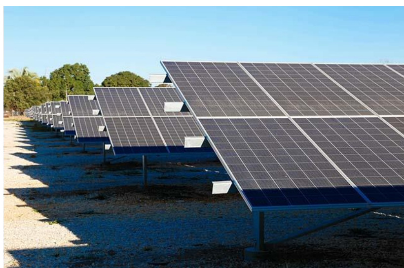
Figura 17 - Sombreamento entre fileiras em usina fotovoltaica com estrutura fixa. Fonte:(POLITEC, 2020).
