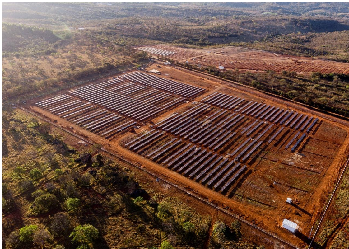
Figura 28 - UFV Stella Maris instalada. Fonte: Autor.
