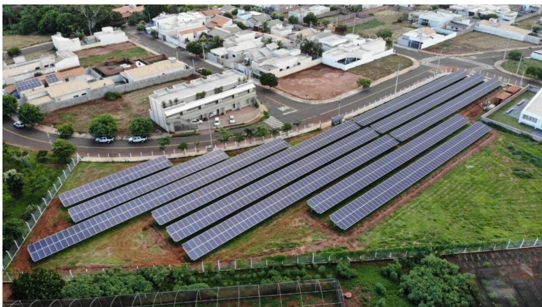
Figura 14 - Exemplo de UFV com estrutura fixa. Instalada no estado de São Paulo. Fonte: (POLITEC, 2020).
