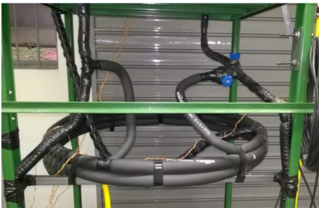
FIG. 3.21: Condensador coaxial instalado na BDC
