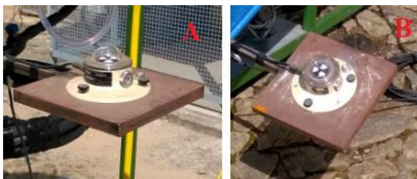
FIG. 3.24: Detalhes dos piranômetros instalados na BDC. (A) piranômetro horizontal e (B) piranômetro inclinado
