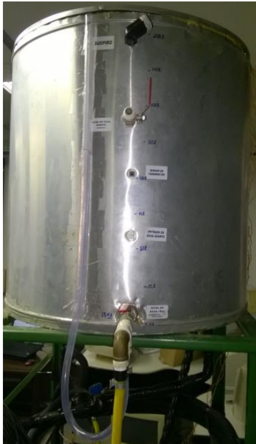
FIG. 3.16: Válvulas e medidor de nível do tanque
