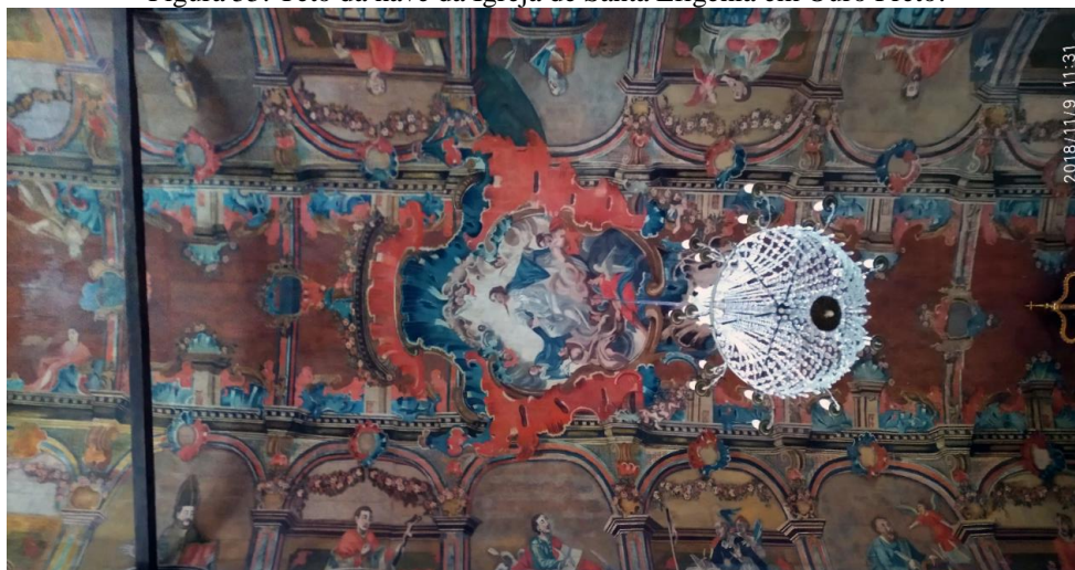
Figura 55: Teto da nave da Igreja de Santa Efigênia em Ouro Preto.
