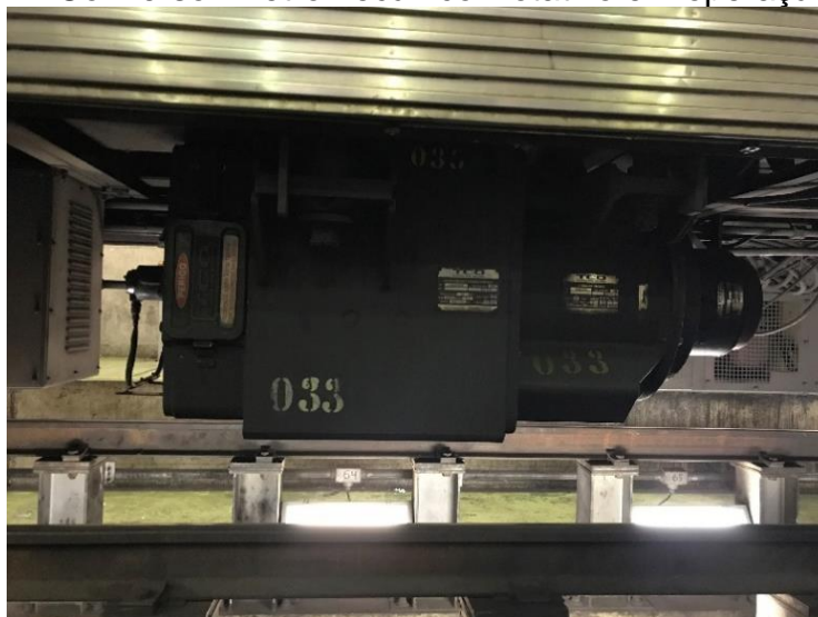
Figura 3.1 - Conversor Eletromecânico Rotativo em operação no trem.
