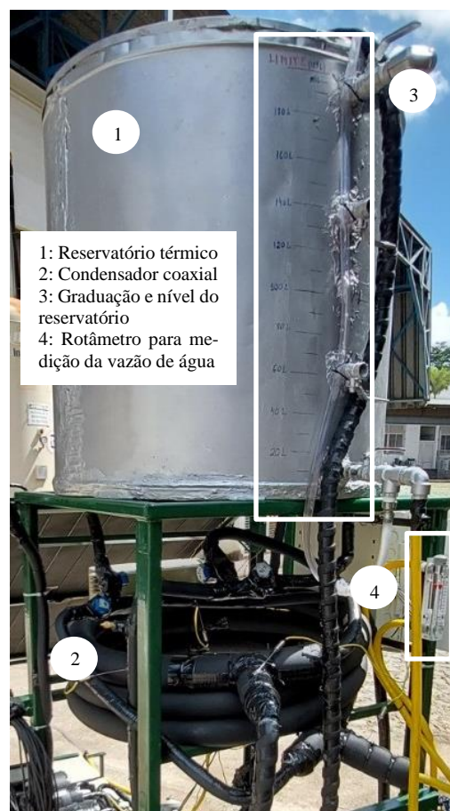
Figura 4.13: Reservatório térmico e condensador coaxial.
