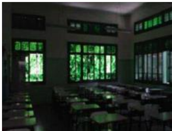
Figura 15. Sala de aula com janelas nas fachadas norte e oeste, em Escola Pública de Juiz de Fora/MG
