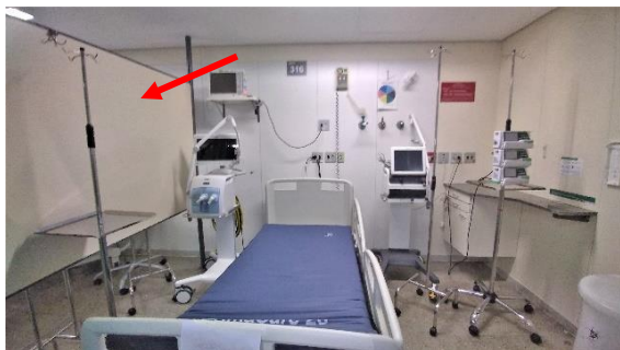
Figura 35 - Divisória entre leitos
