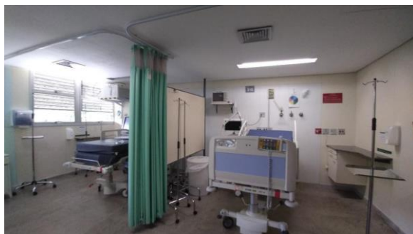
Figura 19 - Senso de controle: iluminação individualizada por leito e cortina e divisórias de leitos no CTI
