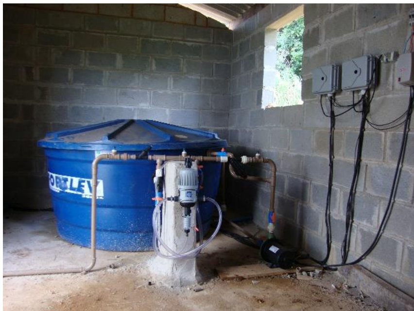
Figura 9 – Galpão para abrigo da caixa d’água, motobomba e outros equipamentos de irrigação.
