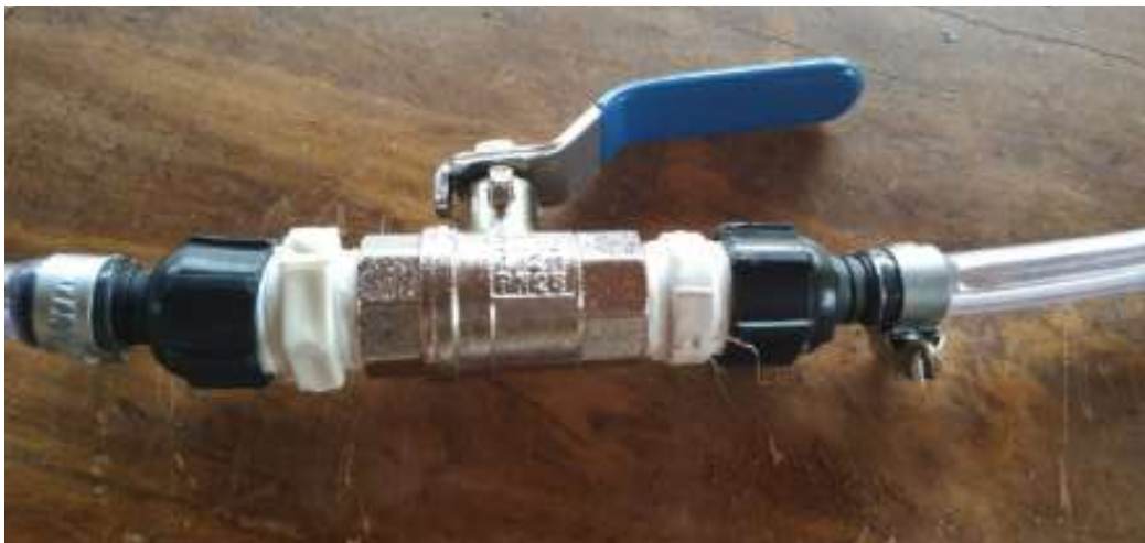
Figura 39 –Montagem do registro para regulação de passagem do biogás.
