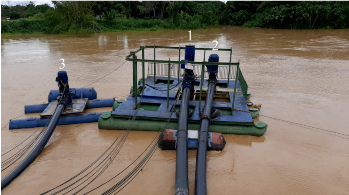
Figura 21. Estação de Tratamento de Água II, Rio Branco, Acre, constituída por um conjunto de bombas verticais do tipo turbina. Nota: 1—Bomba 1; 2 —Bomba 2; e 3 —Bomba 3.
