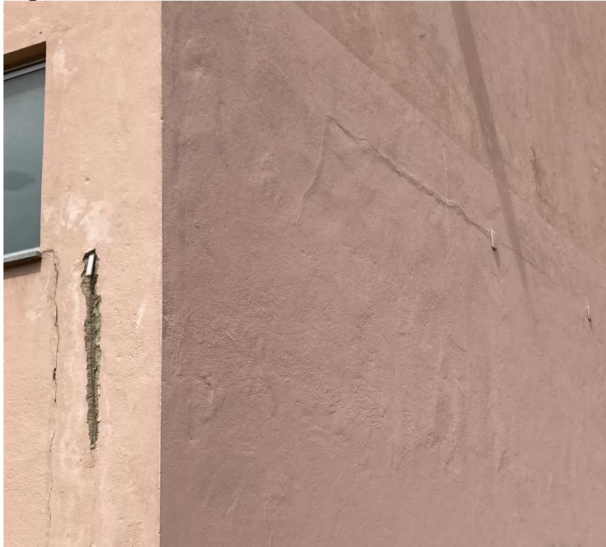
Figura 9 - Fissuras verticais e horizontais
