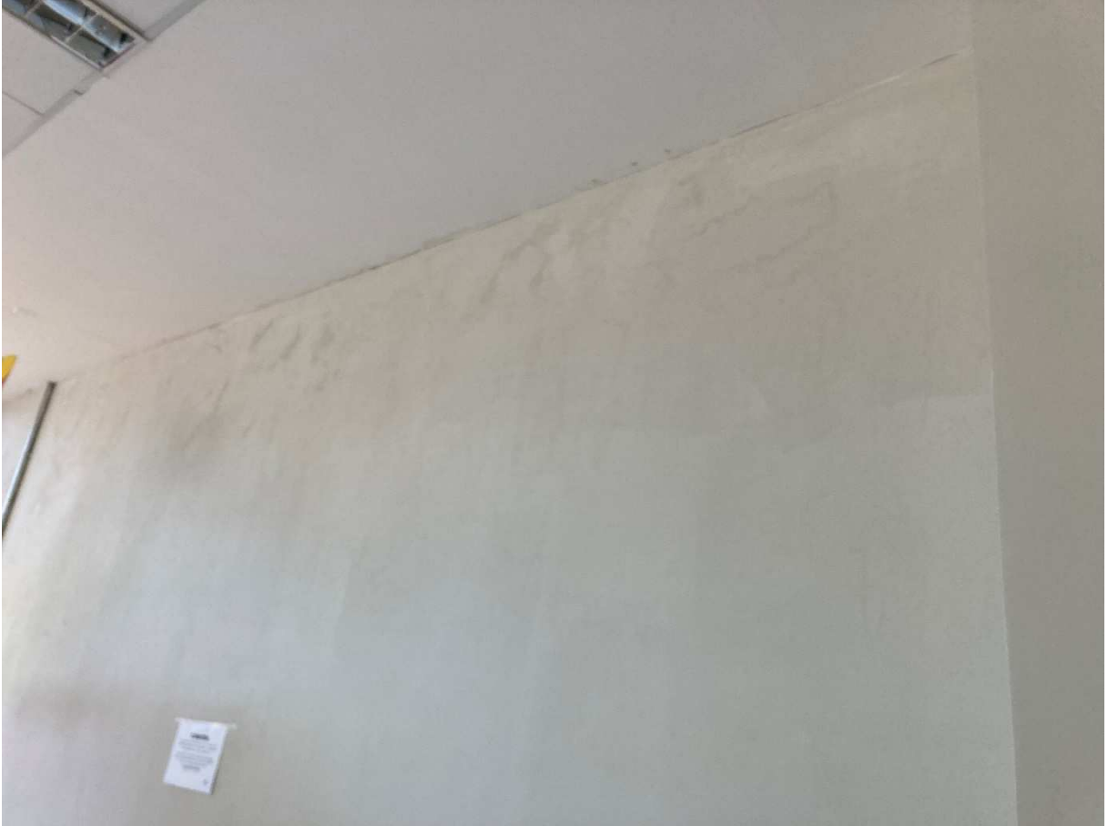
Figura 16 - Infiltração parede interna
