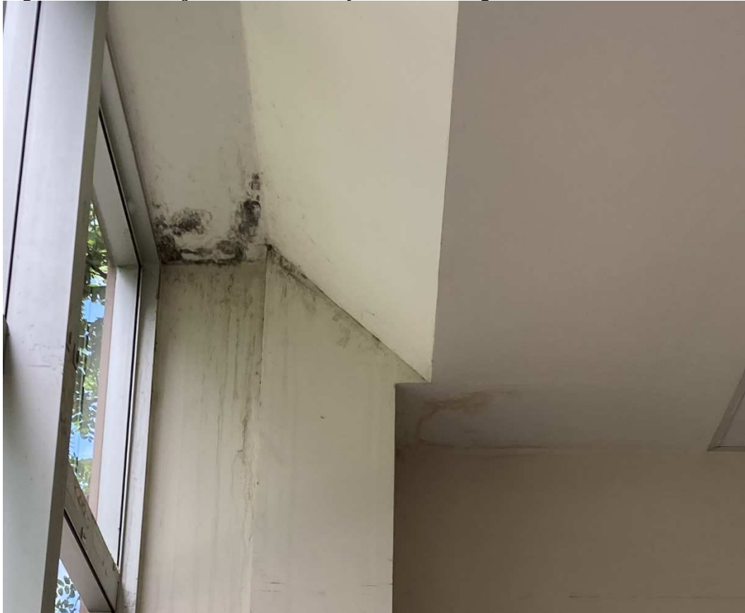
Figura 23 - Infiltração encontro de janela com viga
