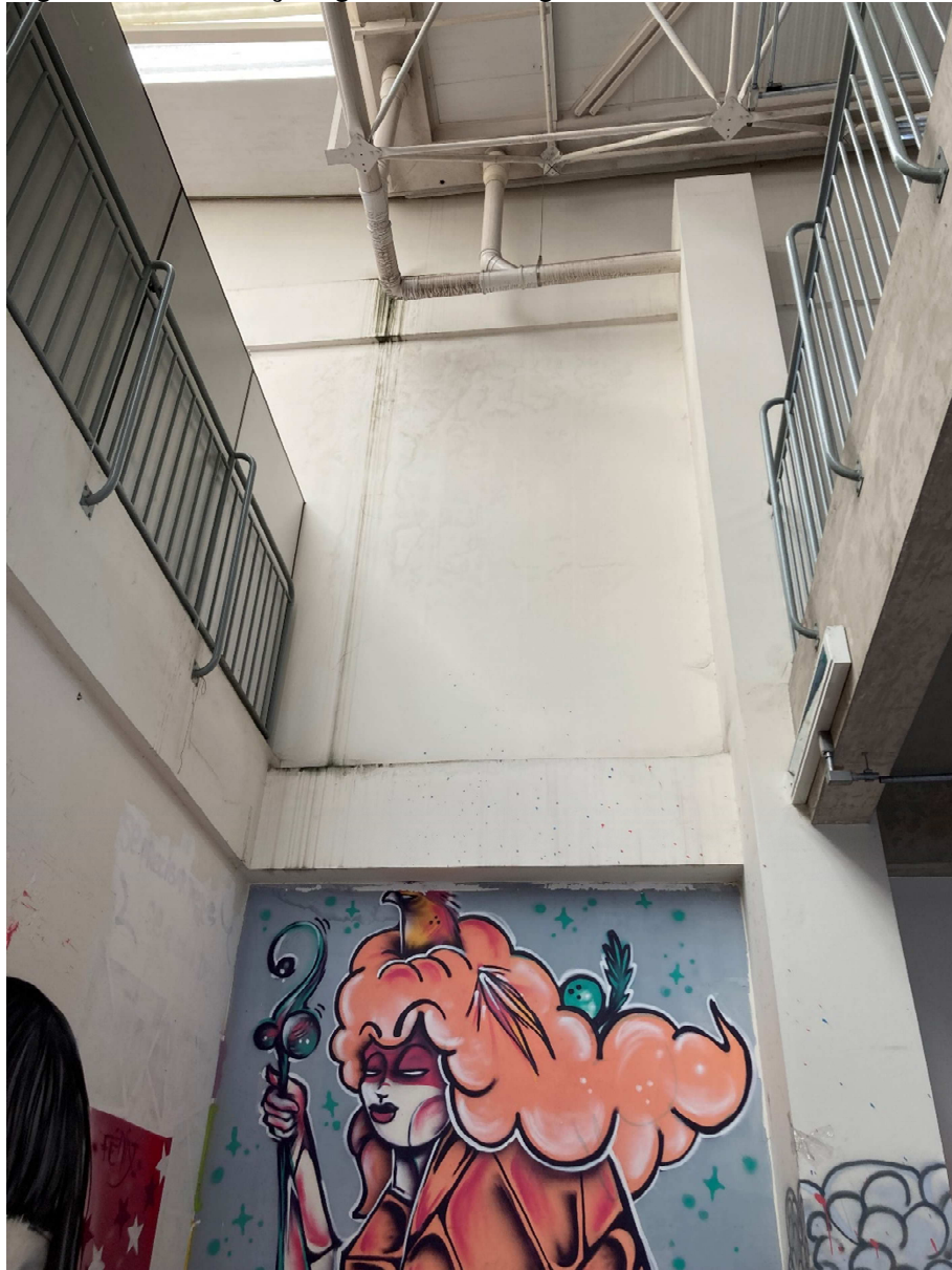
Figura 17 - Infiltração/goteira ao longo de calha
