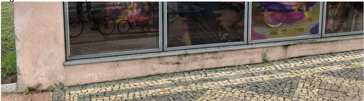
Figura 1 - Manchas, bolor e fissuras
