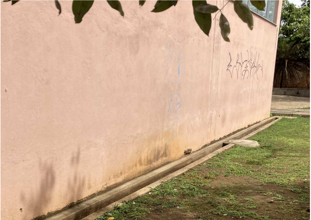
Figura 8 - Fissuras horizontais, eflorescência e bolor
