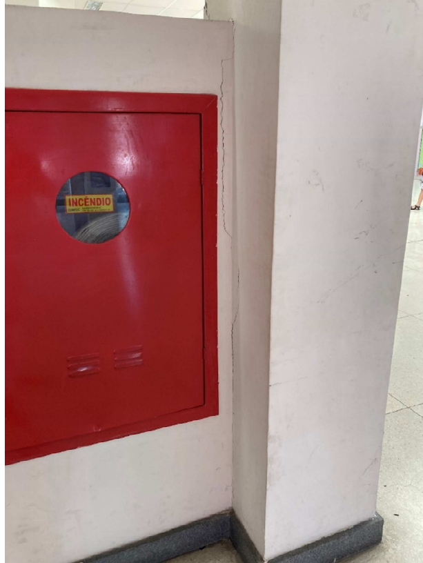
Figura 15 - Fissura vertical no encontro de parede com pilar
