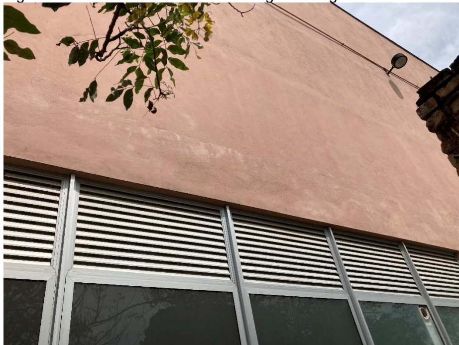
Figura 6 - Fissuras horizontais ao longo das vigas
