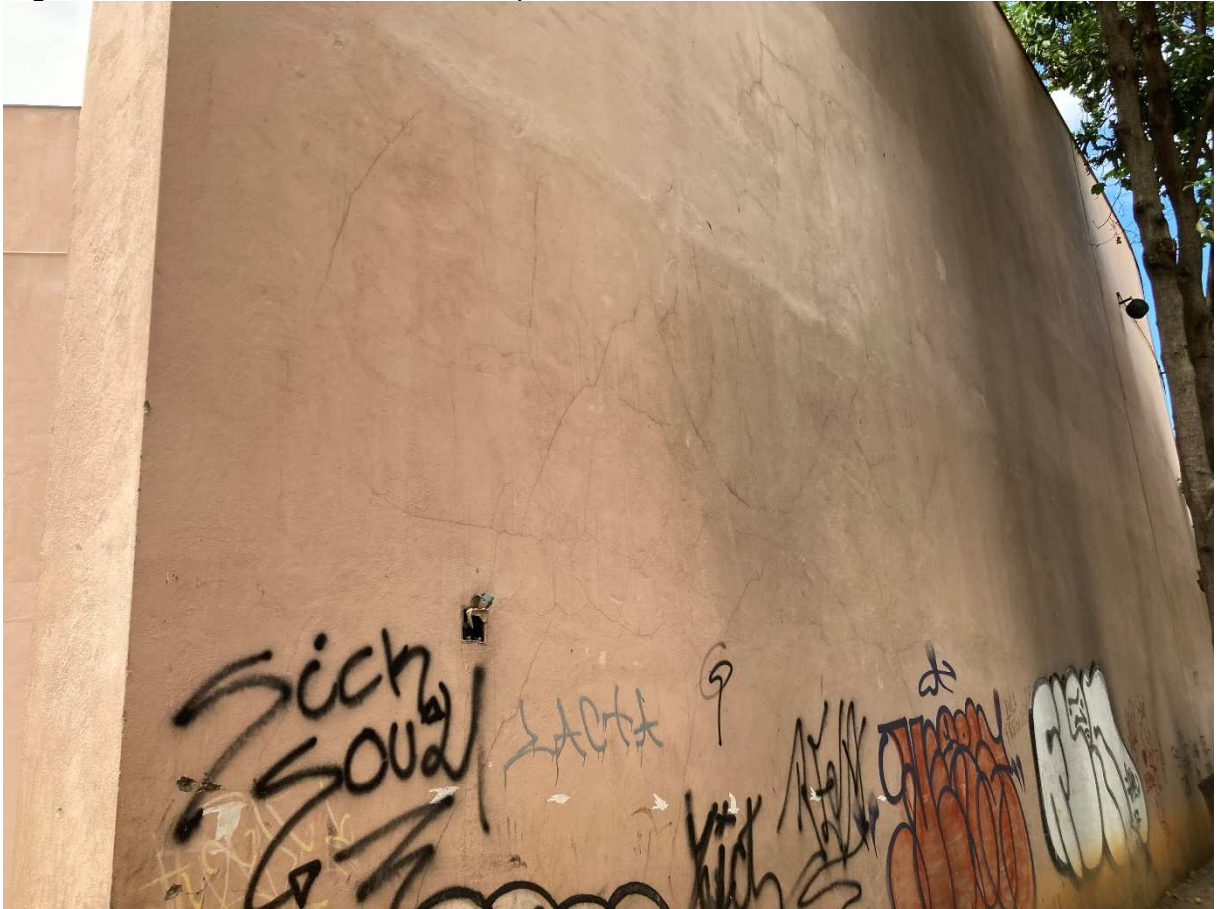
Figura 11 - Fissura horizontais e mapeadas
