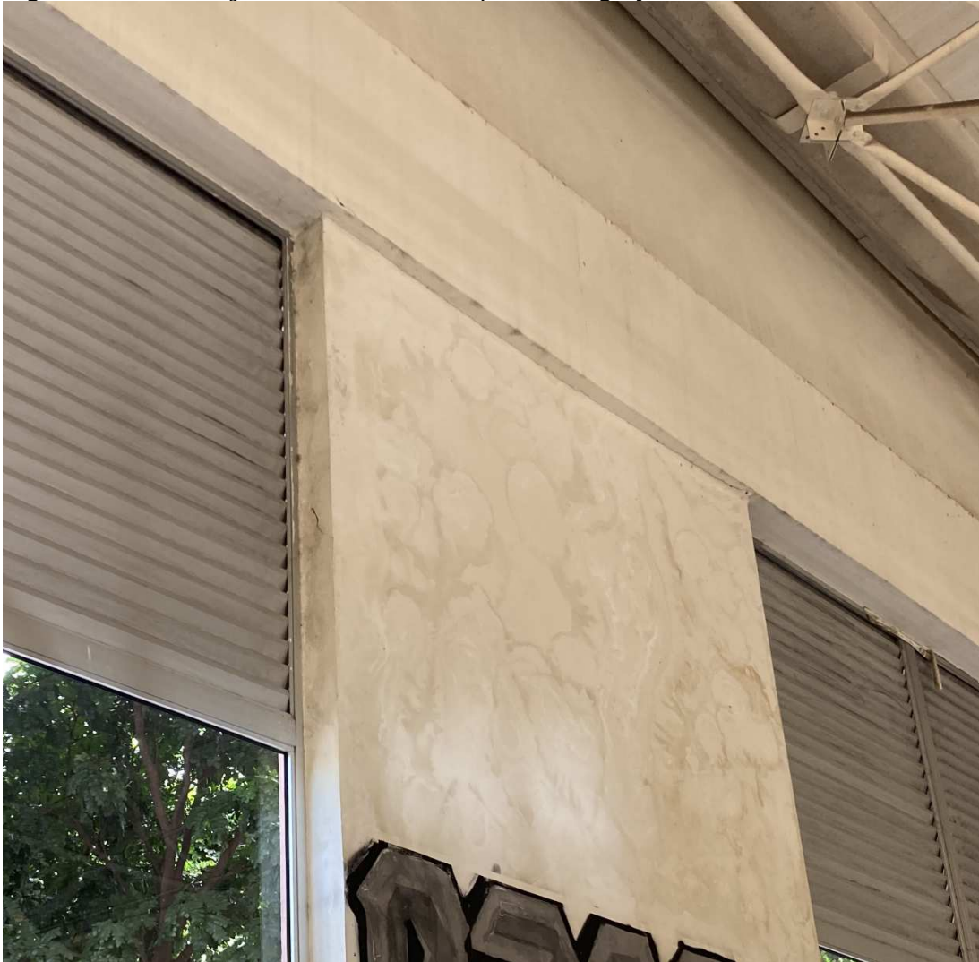
Figura 22 - Infiltração no encontro de parede/viga/janela
