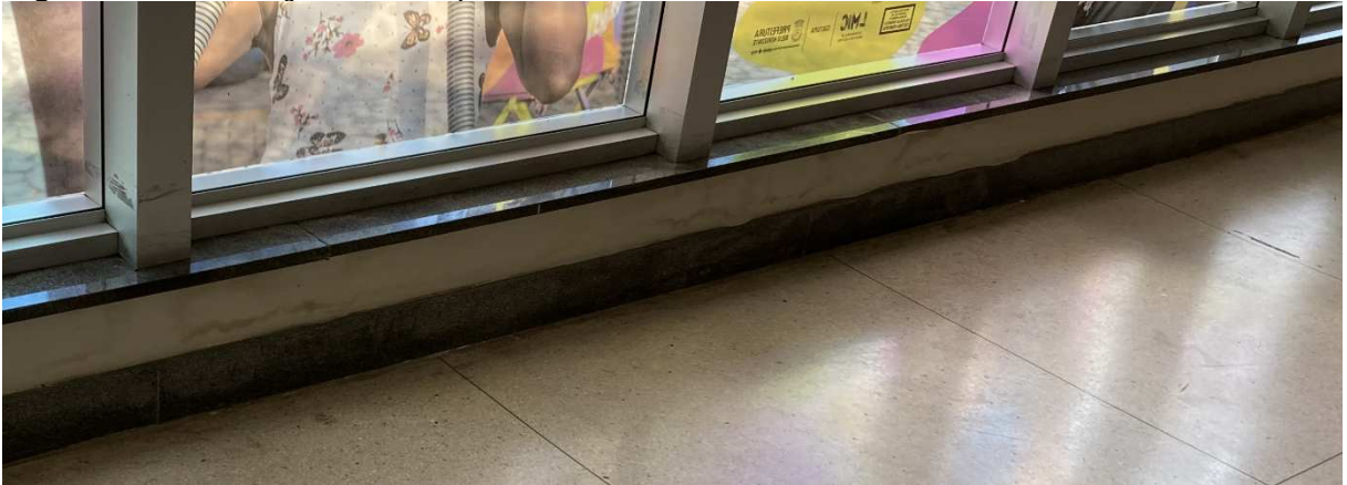
Figura 21 - Infiltração em esquadrias
