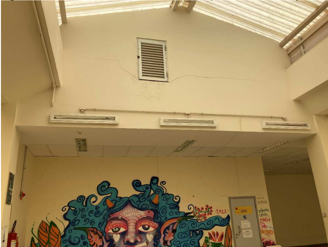
Figura 18 - Trincas e fissuras devido a deformação excessiva da laje
