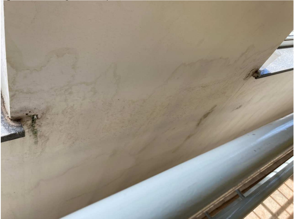
Figura 24 - Infiltração em esquadrias
