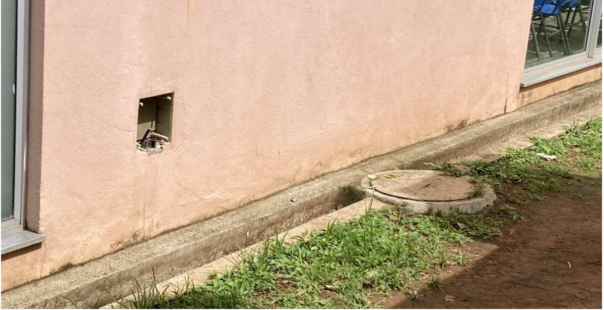
Figura 7 - Fissuras, bolor e encardimento
