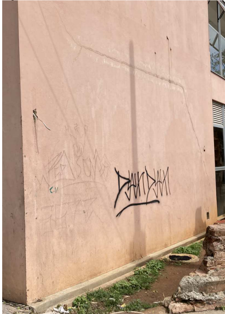
Figura 2 - Fissuras horizontais e inclinadas
