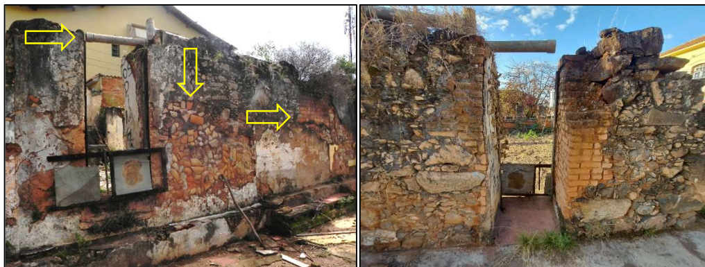
Figura 32. Presença de tijolos, fragmentos de telhas nas paredes e tubulações nas ruínas (a partir dos espaços 18 e 21). Fotografias: Marcio Machado (2019); Caroline Ferreira (2020).
