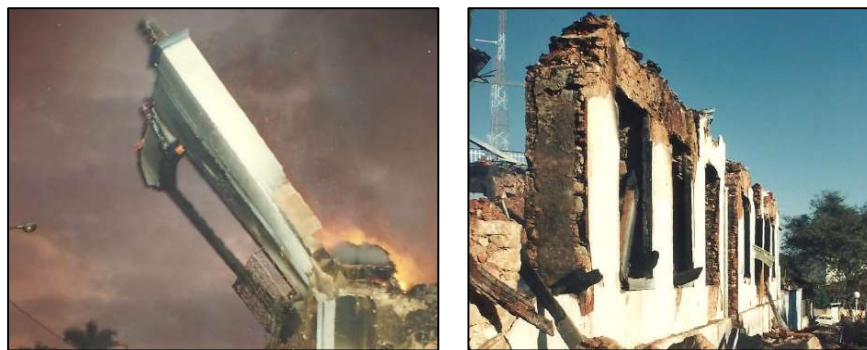
Figura 15. À esquerda: balcão e parede do pavimento superior, possivelmente em pau a pique, durante o incêndio de 1996. À direita: paredes e colunas do pavimento inferior em alvenaria de pedras irregulares. Fotografia: Foto Fênix, 1996.
