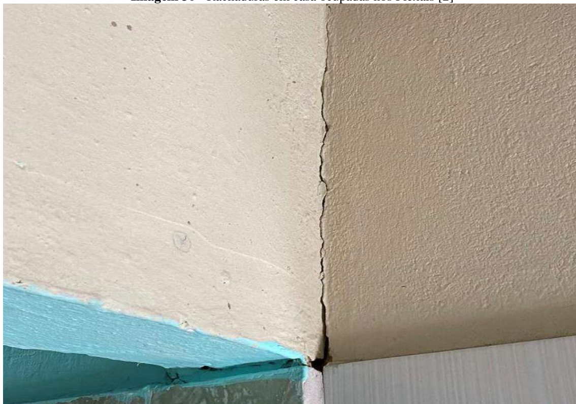
Imagem 30 - Rachaduras em casa ocupadas nos Flexais [2]
