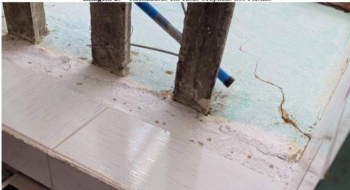
Imagem 29 - Rachaduras em casas ocupadas nos Flexais
