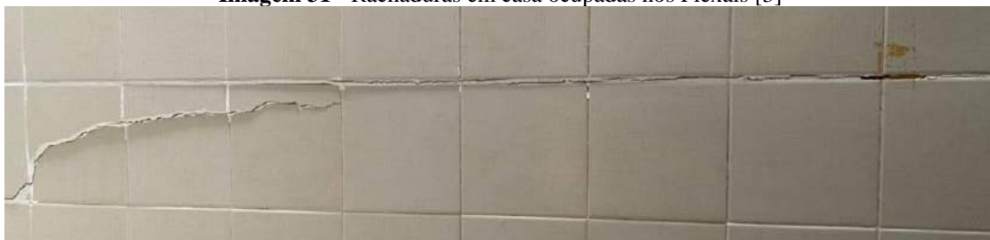
Imagem 31 - Rachaduras em casa ocupadas nos Flexais [3]
