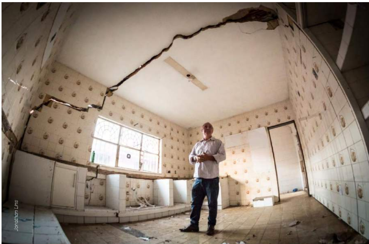
Morador revive drama por deixar imóvel condenado pela Defesa Civil
