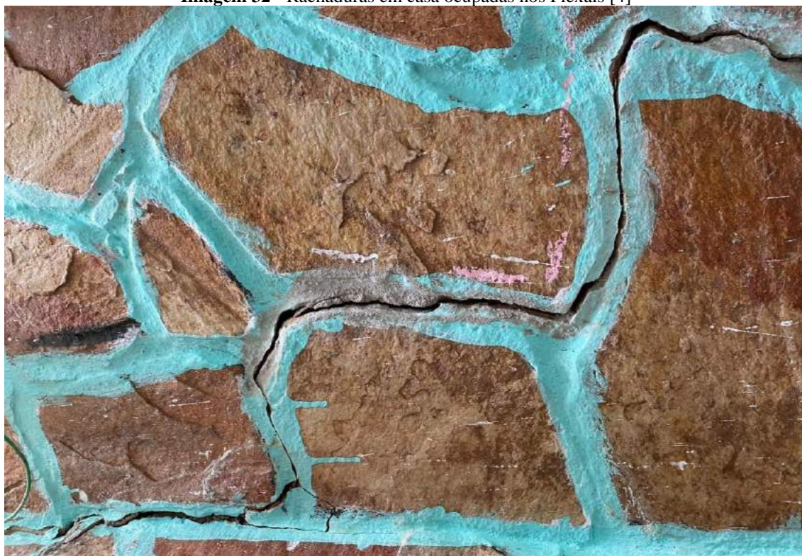
Imagem 32 - Rachaduras em casa ocupadas nos Flexais [4]
