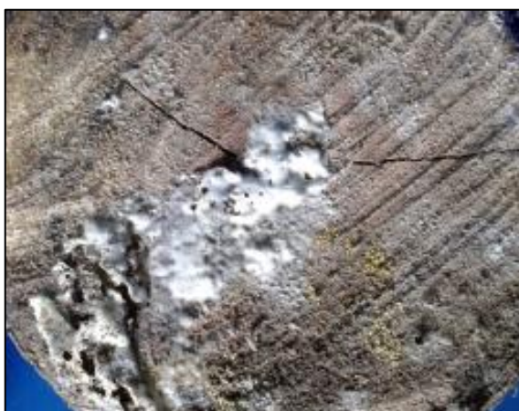
Figura 211 - Bolor em madeira de Cajueiro recém cortada
