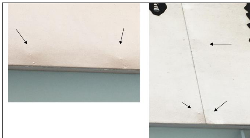
Figura 159 - Marcas de parafusos de fixação e relevos nos painéis
