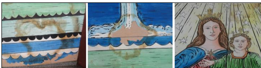
Figura 136 - Manchas generalizadas na obra
