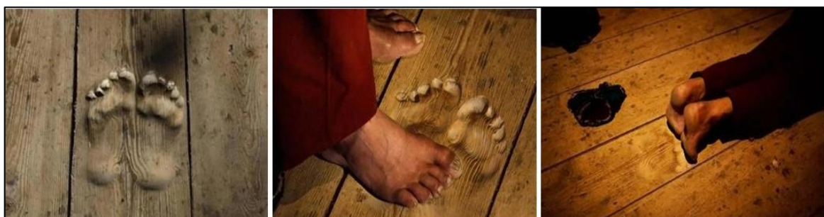
Figura 212 - Deformação devido ao uso
