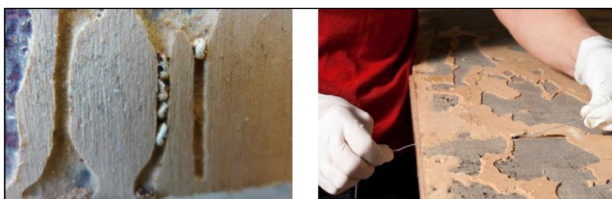
Figura 94 - Infestação por cupins. Verso da obra
