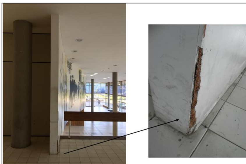
Figura 157 - Perda de suporte e camada pictórica
