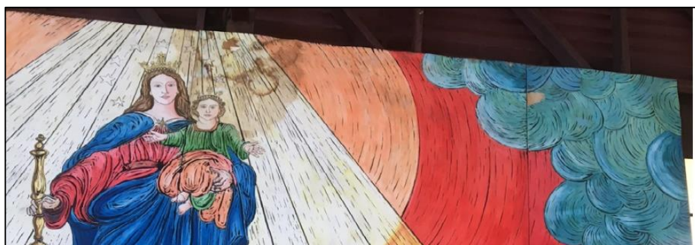
Figura 140 - Danos: manchas, desprendimentos, abaulamentos do suporte
