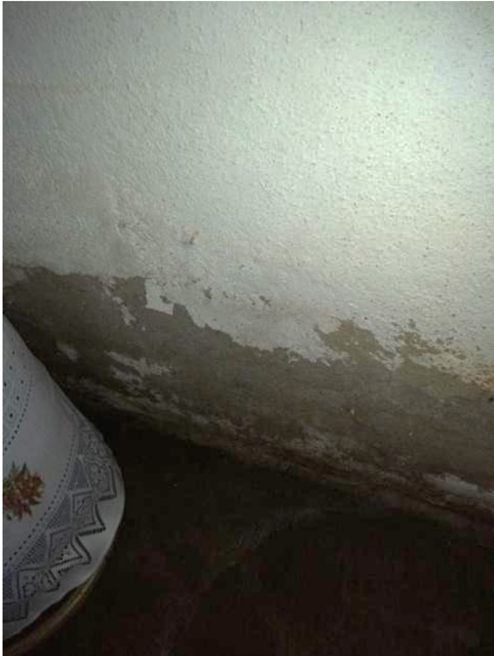
Figura 14 - Patologias: Pintura descascando
