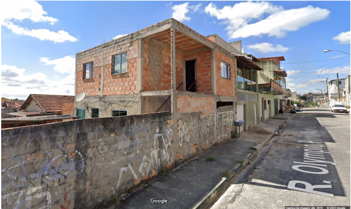
Figura 24 - Pilar com armadura exposta.
