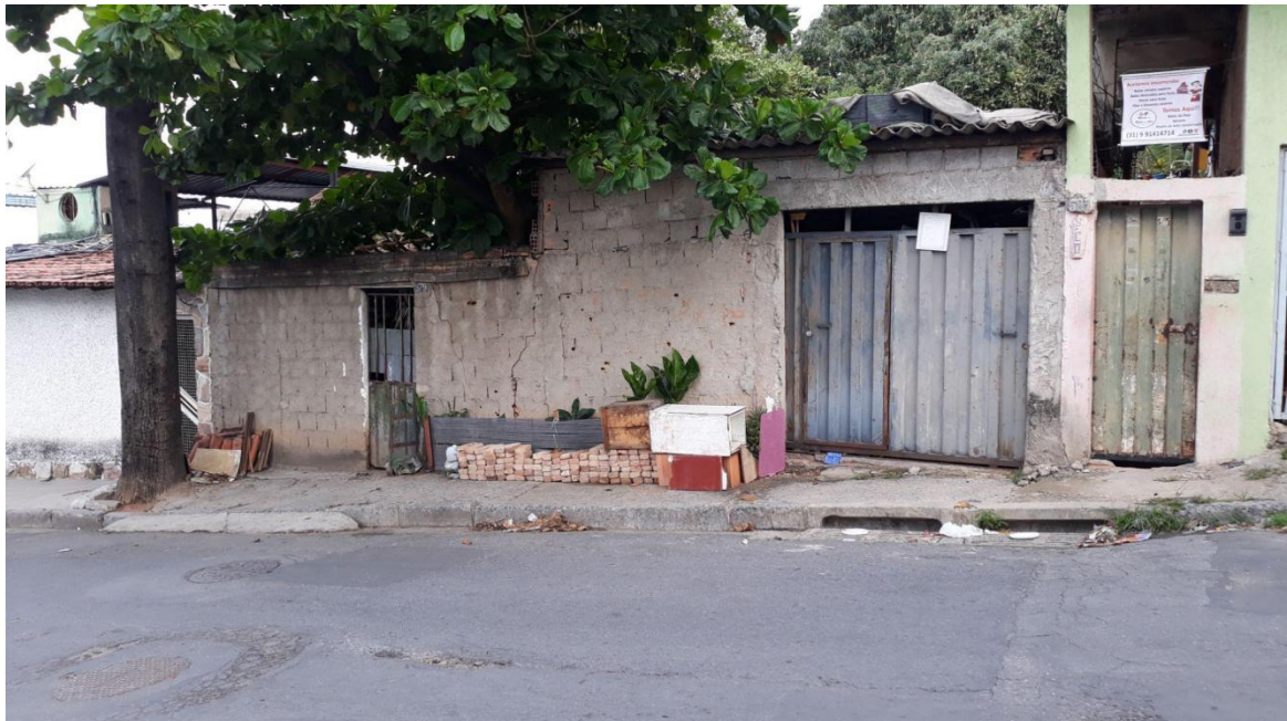
Figura 23 - Muro com trincas.
