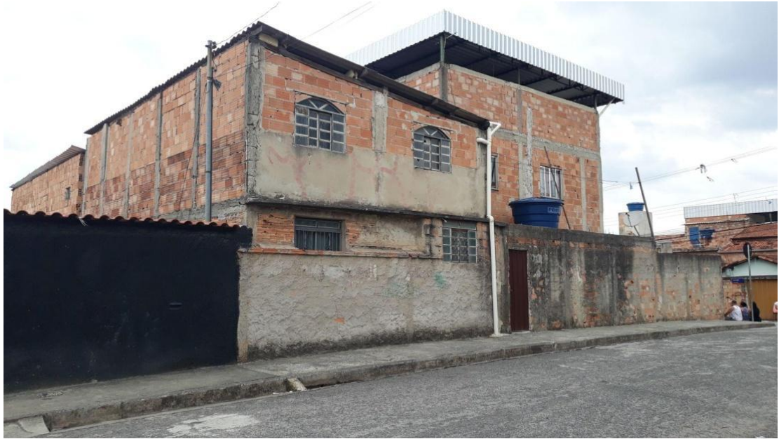
Figura 22 - Moradia sem afastamento nas divisas, esquadrias sem verga e contra-verga, e pilares mal dimensionados.
