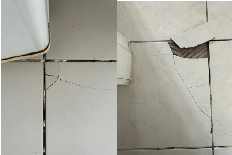
Figura 15 - Patologias: Fissuras e quebra do revestimento
