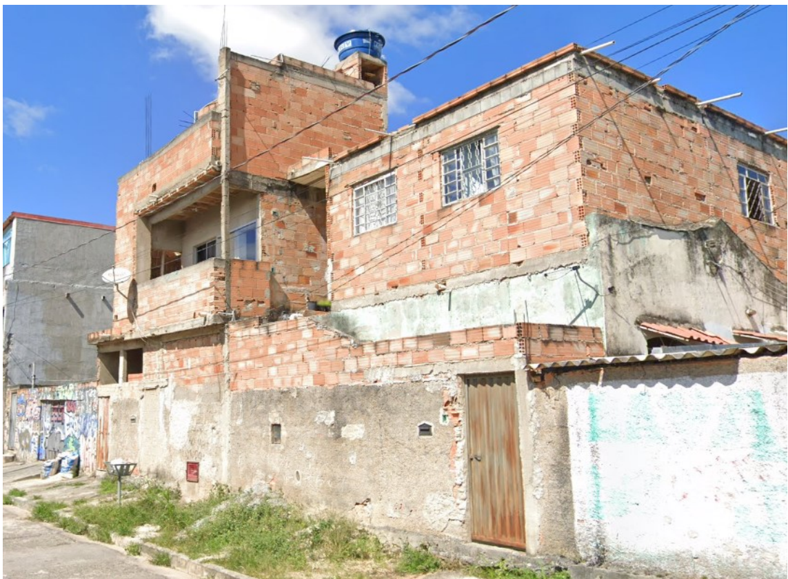
Figura 25 - Estrutura mal dimensionada
