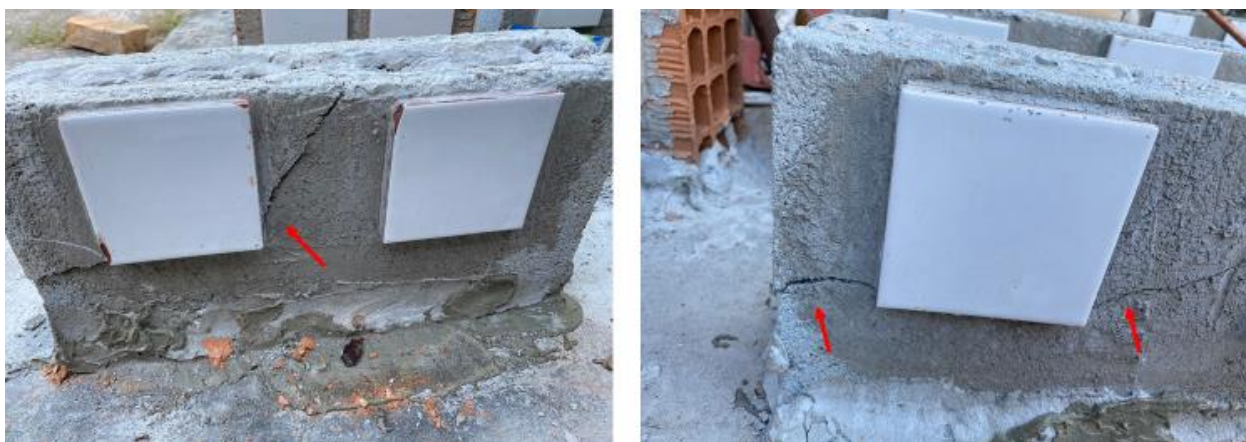
Figura 43 – Trincas que surgiram na ruptura do bloco com ângulos aproximados de 45°
