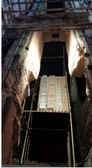
Figura 10 – Pilar e vigas de concreto armado danificados no Silo
