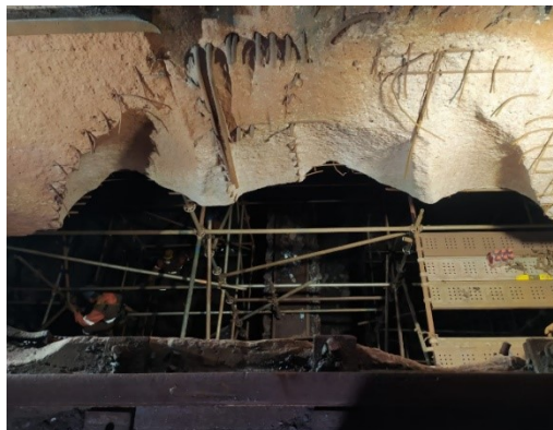
Figura 9 – Vigas de concreto armado danificadas no Prédio da Rebritagem
