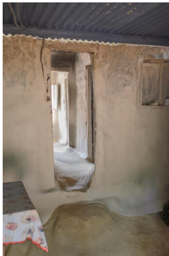
h) diferença de nível entre a cozinha e parte mais antiga da casa
