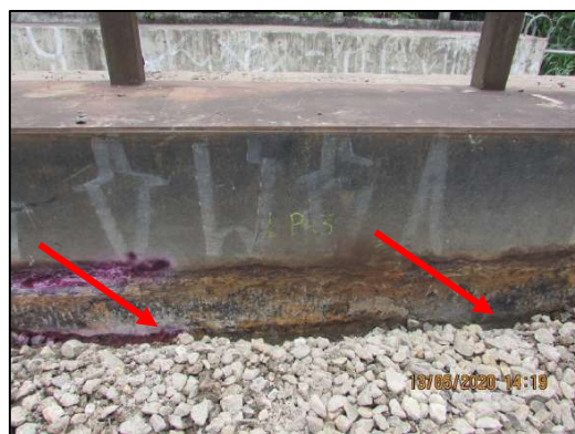
Figura 7 – Tentativa de ensaio de líquido penetrante na alma da viga caixão.
