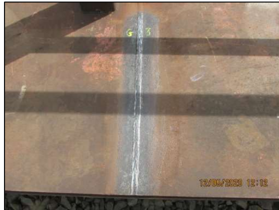
Figura 8 - Ensaio de ultrassom na junta transversal de mesa superior de viga principal.
