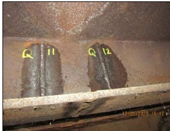
Figura 11 - Ensaio de ultrassom nas juntas transversais de alma das transversinas.
