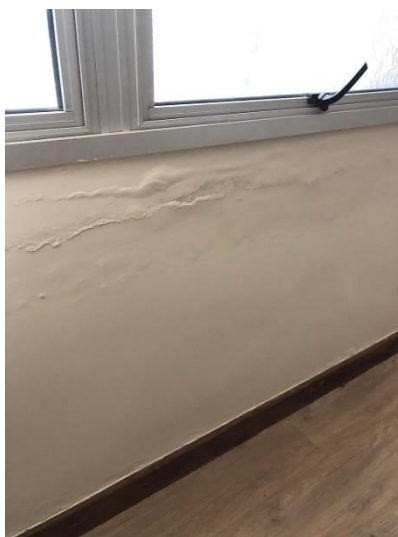
Figura 6 – Deterioração por umidade ascendente.
