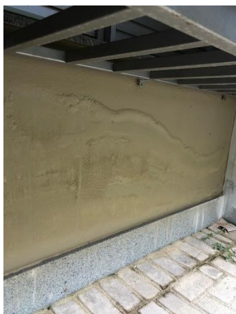
Figura 10 – Deterioração por umidade ascendente.
