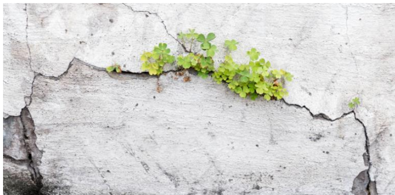
Figura 3 – Ação biológica em alvenaria
