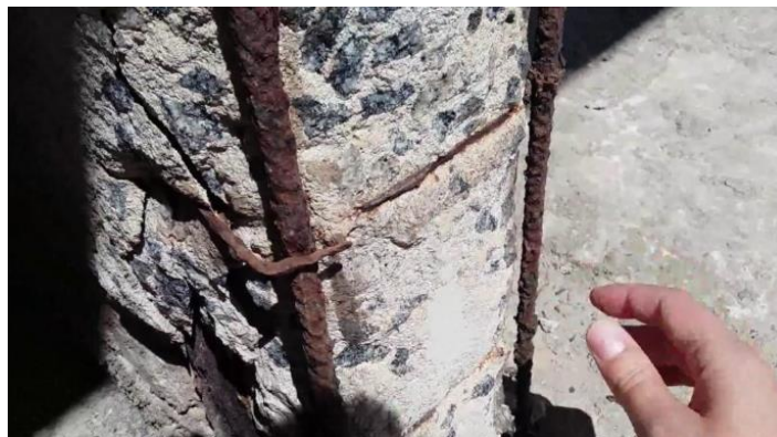
Figura 4 – Elemento em processo de corrosão
