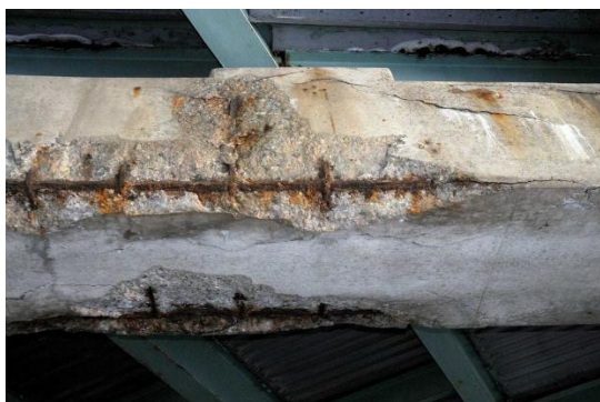
Figura 2 – Elemento em processo de carbonatação
