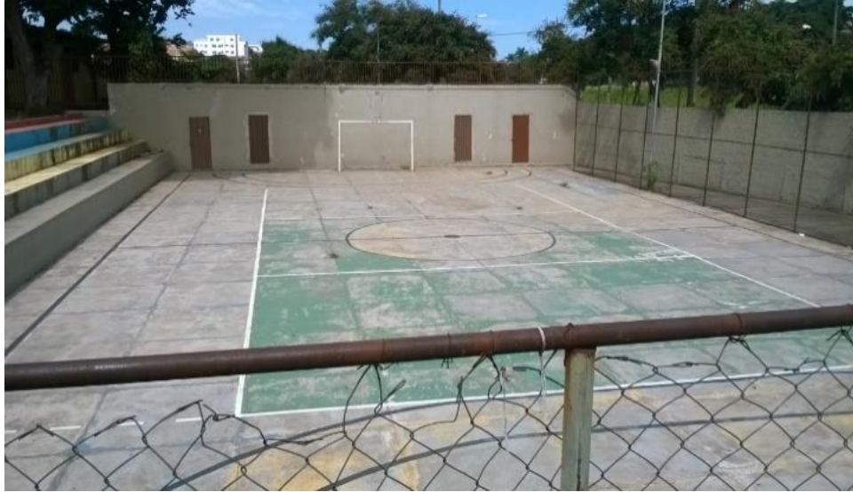
Figura 14 - Quadra esportiva antes da reforma
