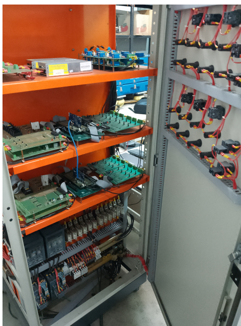
Figura 54 – DSP F28379D e placas de aquisição de sinais.
