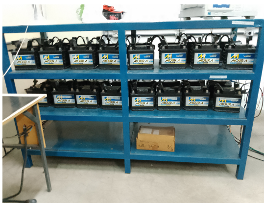
Figura 55 – Bancos de baterias e sua disposição em prateleira metálica.
