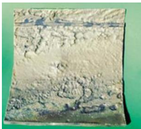
Figura 2.4- Parte interna de um trecho de tubulação, evidenciando a deterioração por erosão (GENTIL, 2007).
