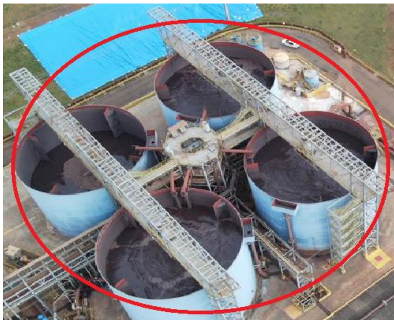
Figura 3.11 - Tanques de homogeneização localizados em EB1.
