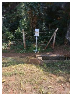
Figura 43- Manancial Catarina – Elevatória
