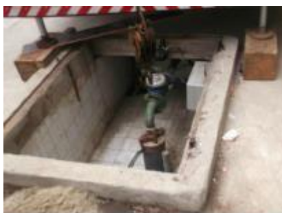
Fotografia 1 – Cavalete do poço tubular profundo em estudo
