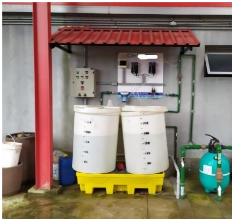
Fotografia 2 – Estação de tratamento de água
