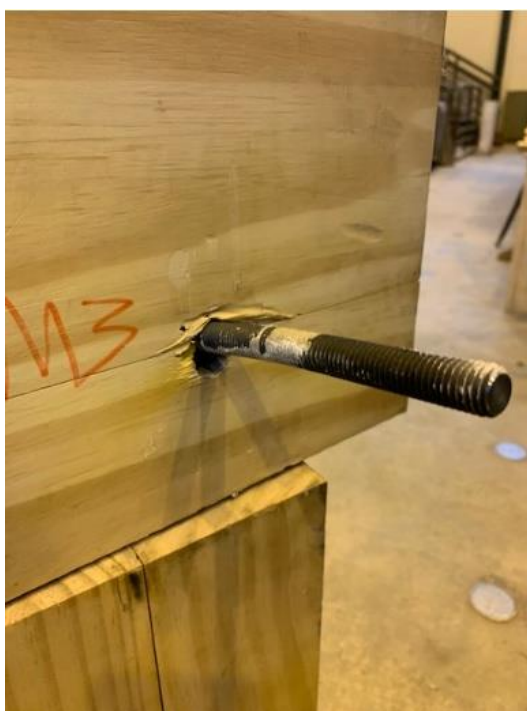
Figura 6.65 – Esmagamento da madeira e rótulas plásticas no modelo M5 de madeira/madeira
