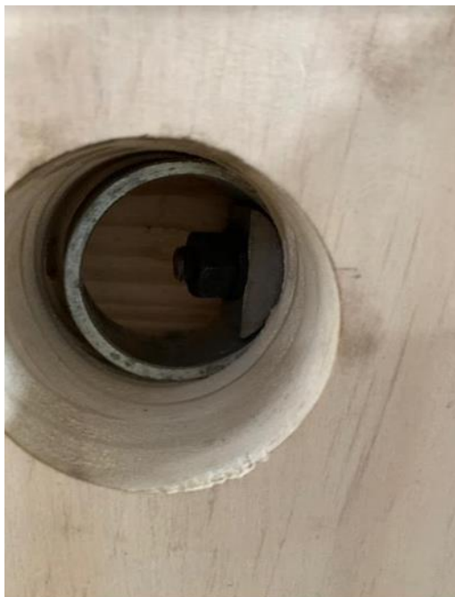
Figura 6.32 - Penetração do anel de aço
