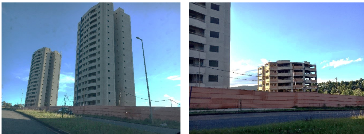
Foto 1 - Mosaico de fotos de torres em construção pela RKM Engenharia, na Av. Wimbledon
