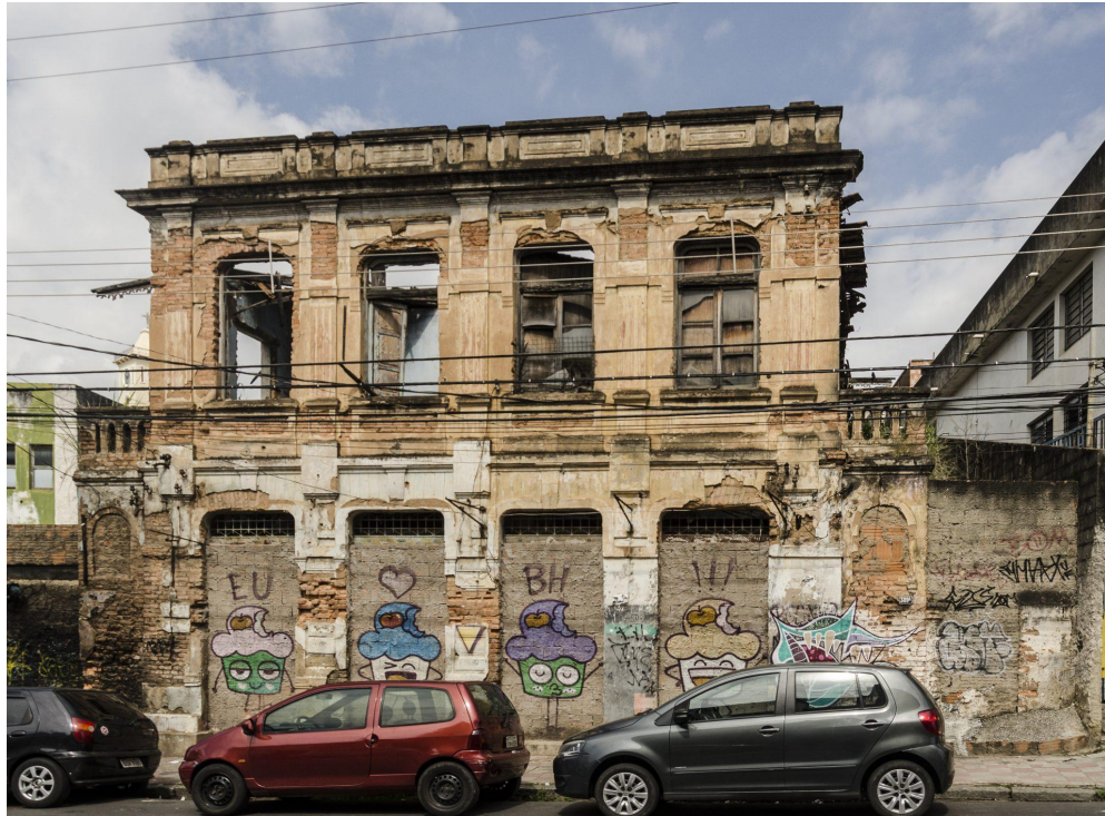
FIGURA 7 - Fachada de edificação tombada na Lagoinha
