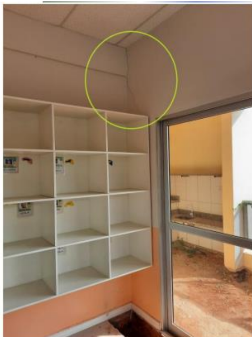
Figura 37 - Trincas diagonais. Fonte: Acervo fotográfico da escola, 2021.
