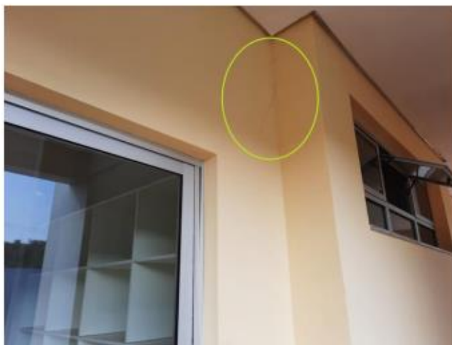
Figura 36 - Trincas diagonais. Fonte: Acervo fotográfico da escola, 2021.
