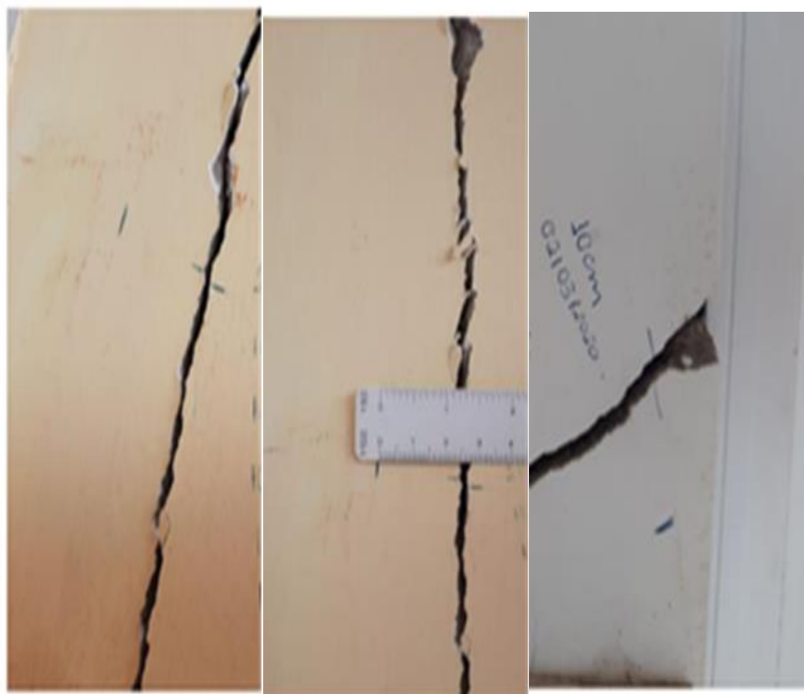
Figura 7 - Trincas no revestimento externo de fachada da unidade de ensino infantil. Fonte: Acervo fotográfico da escola, 2021.
