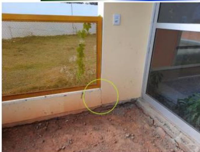
Figura 39 - Fissura na alvenaria. Fonte: Acervo fotográfico da escola, 2021.
