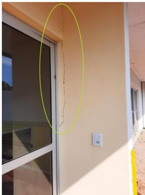
Figura 38 - Trinca na junção de alvenaria. Fonte: Acervo fotográfico da escola, 2021.
