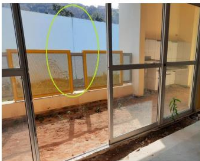
Figura 40 - Trinca no muro. Fonte: Acervo fotográfico da escola, 2021.
